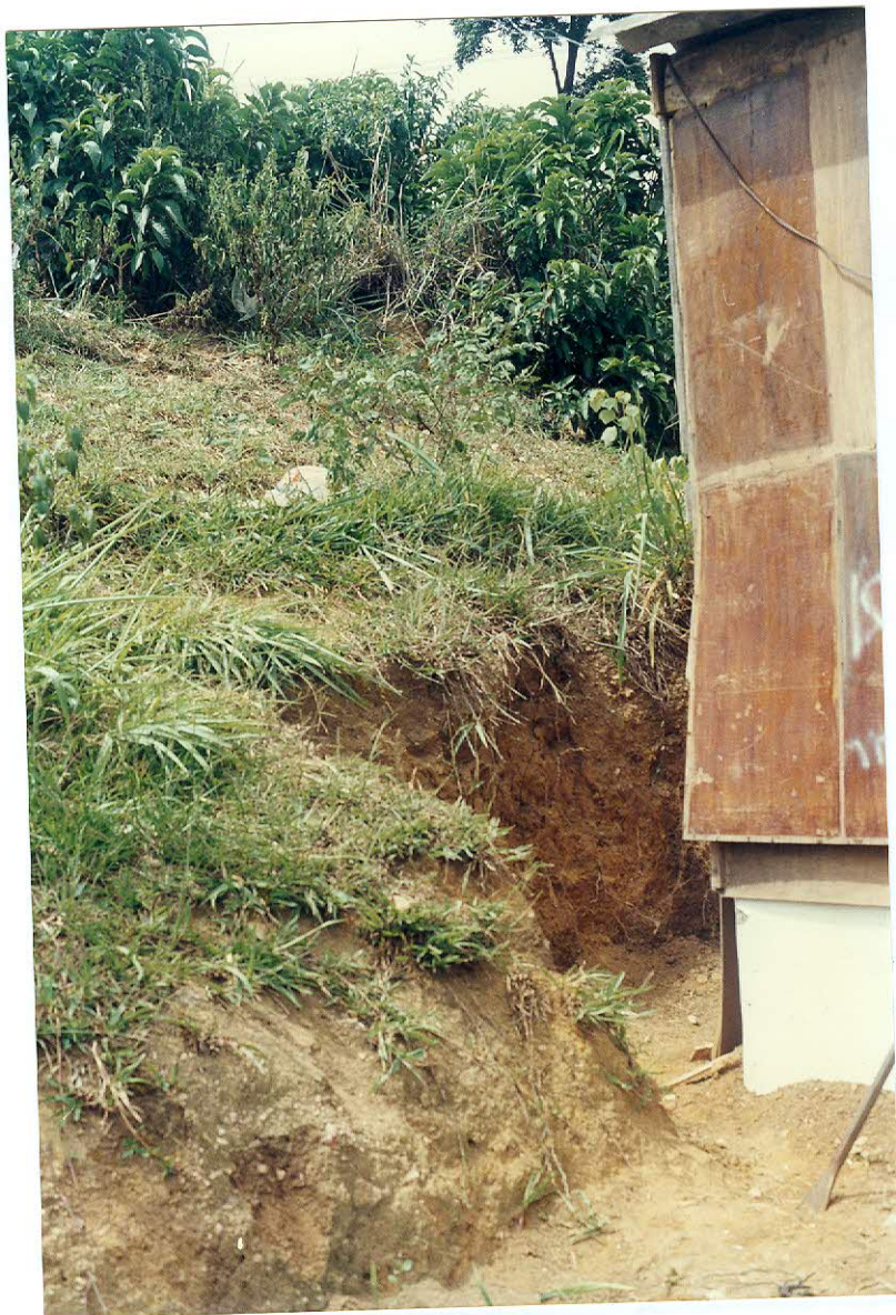
Figura 28. Corte em talude na Associação de Moradores Fazenda Mato Alto.
