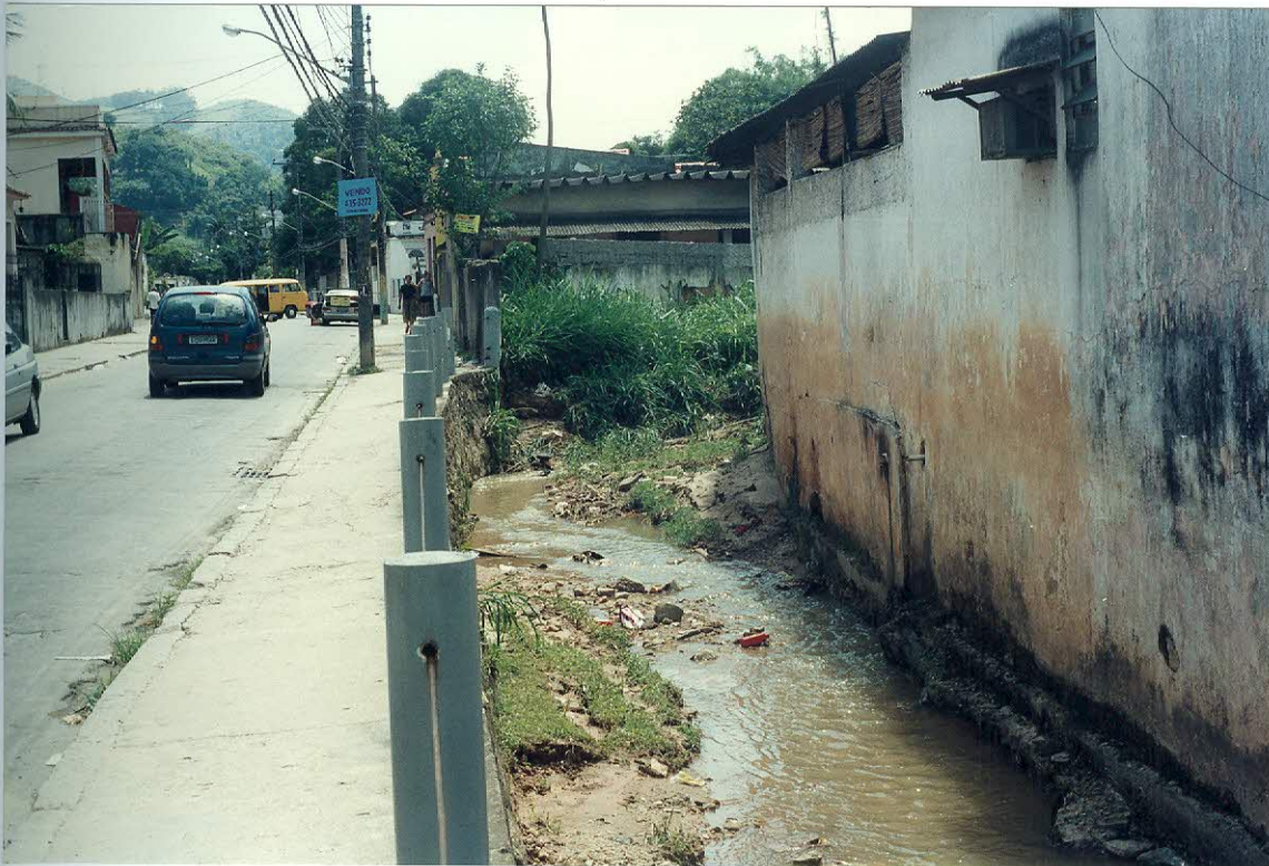
Figura 11. Assoreamento e marcas do nível atingido pelas águas, por ocasião de enchentes, em trecho do rio Covanca, no Largo do Tanque.
