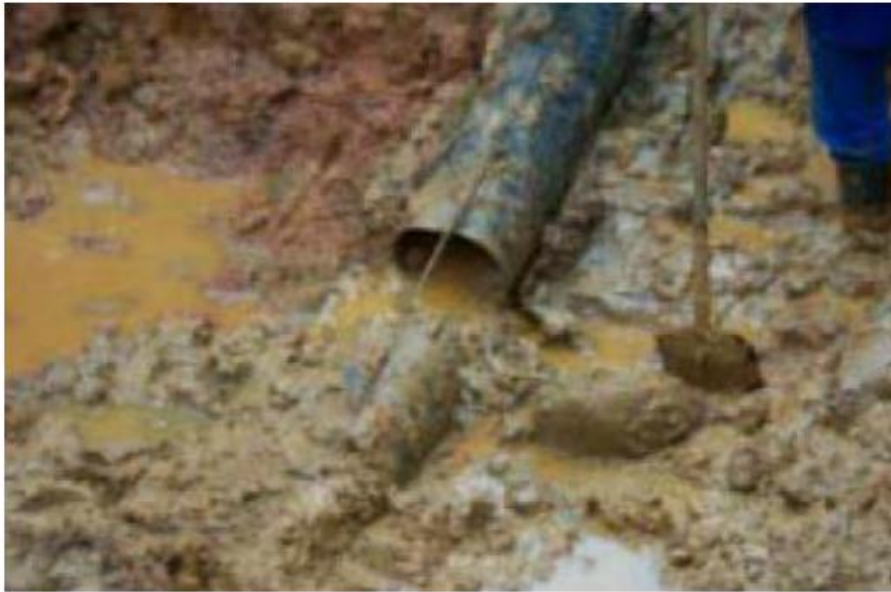
Figura 2.9 - Ruptura por tração no duto OLAPA. Fonte: Soares e Musman (2001).
