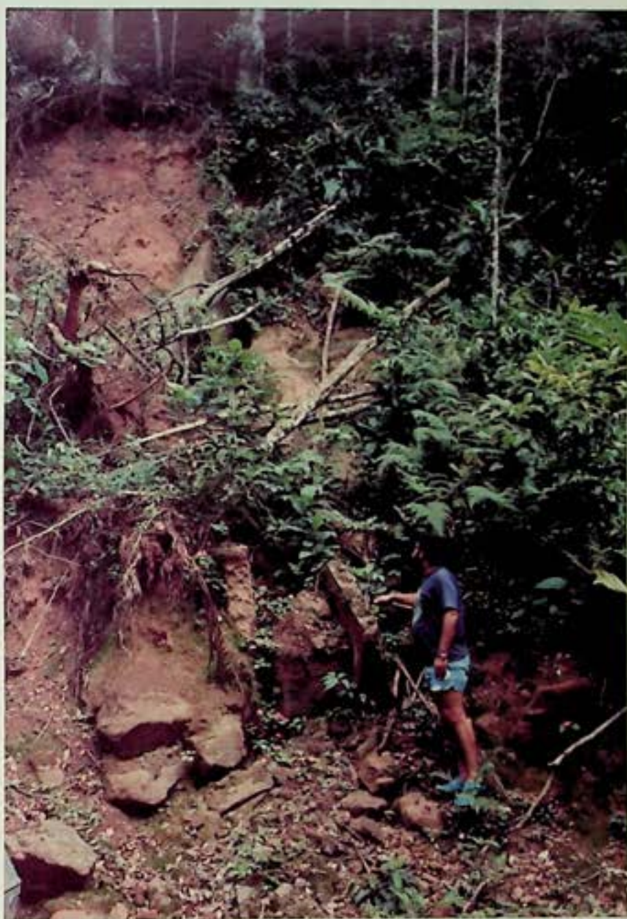
Foto 1 - Escorregamento com mobilização de dissipador de energia em forma de degrau.
