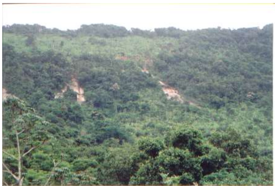
Figura 91: Deslizamentos ocorridos em 2003, na porção da encosta sem depósitos de blocos rochosos.
