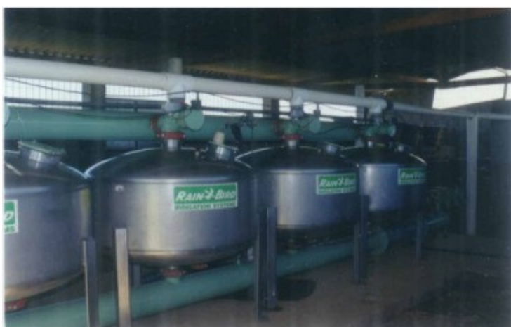
Foto 50 - Detalhe do sistema de filtragem da água para irrigação por micro-aspersão. Fazenda Agrodan, Belém do São Francisco, maio/2003, foto do autor.
