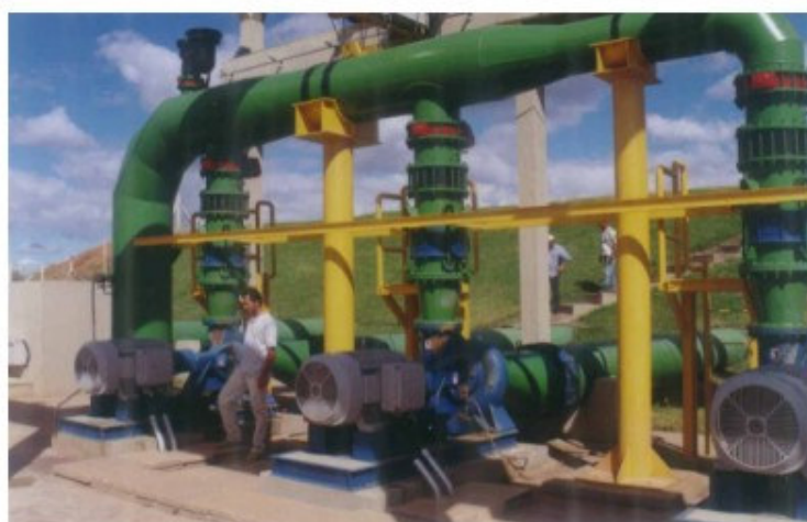
Foto 48 - Detalhe do sofisticado sistema de bombeamento d'água para irrigação do Projeto Caraibas em Sta Maria da Boa Vista, julho/2003, foto do autor.
