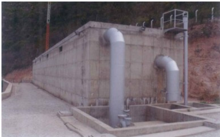
Foto 43 - Estação elevatória da adutora do oeste, que capta água do São Francisco, na altura de Orocó, transpondo-a até a região do Araripe, julho/2003, foto do autor.
