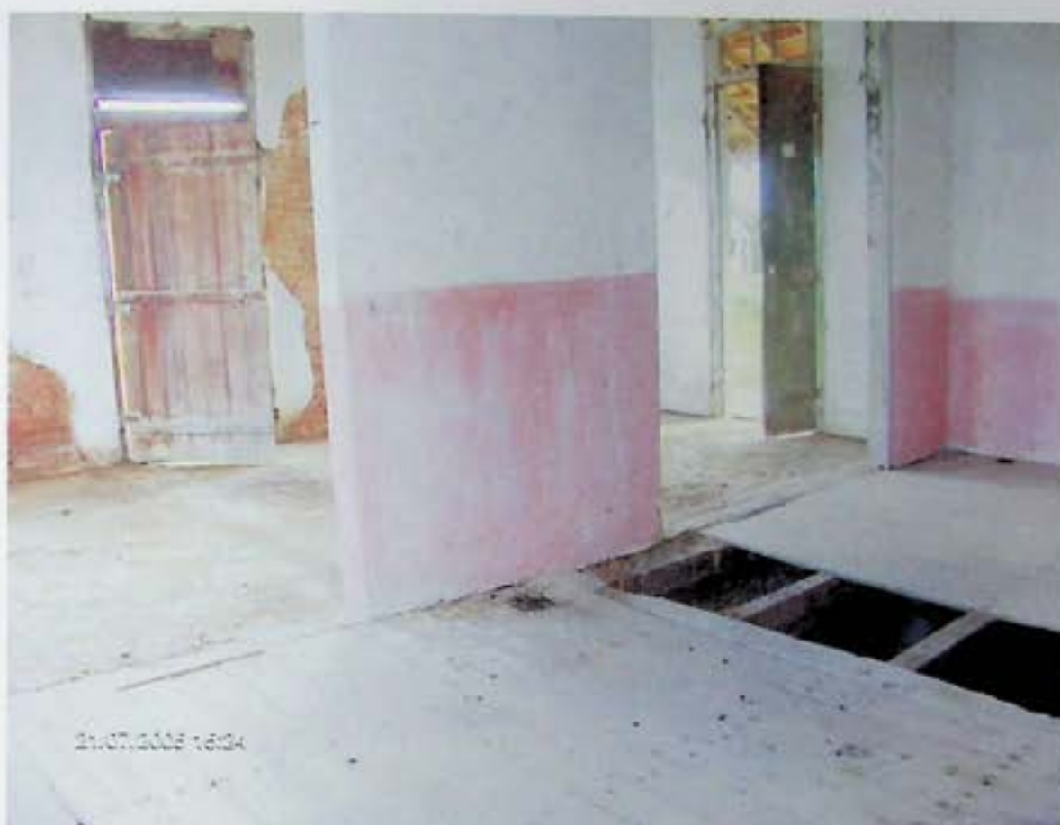
Foto 11: Espaço interno do antigo casarão de mantimentos da Usina São João: necessidade de reformas
