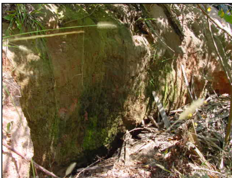
Figura 4.18. Erosão originada da compactação dinâmica do talude de aterro. Nota-se o afloramento de uma alcova de regressão remanescente, entulhada com o material do talude.
