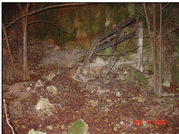
Figura 4.16. Erosão entre a estação Bt4 e Bt11, observando-se a barreira de Pallet quebrada.
