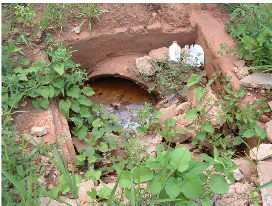
Figura 35. Afogamento de drenagens pluviais devido à subida do lençol freático resultante do efeito "gota de mercúrio" - Aterramento de área pantanosa da nascente do córrego Renato.
