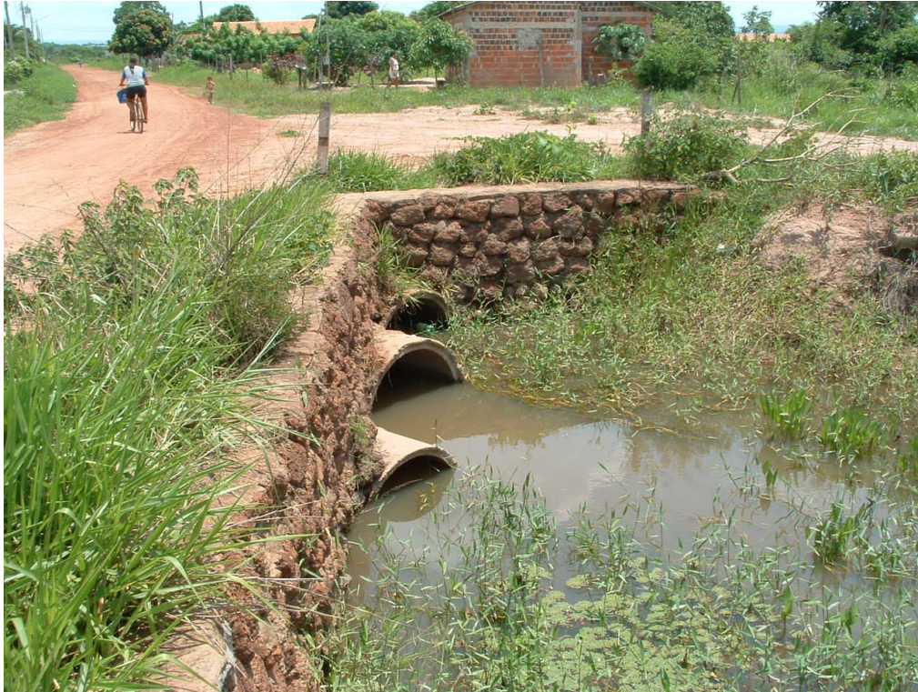
Figura 36. Canal dos Fontes, passagem sob a rua Joaquim Murtinho. Afogamento de drenagens pluviais Foto: A. Rosestolato Filho, 2003.
