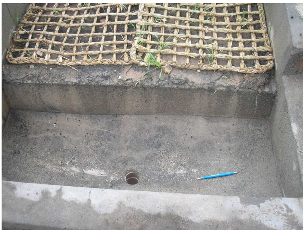
Figura 96 – Sedimentos depositados na calha da parcela com geotêxteis.
