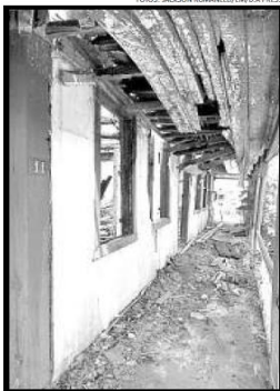
Casarão antigo foi danificado por um incêndio
