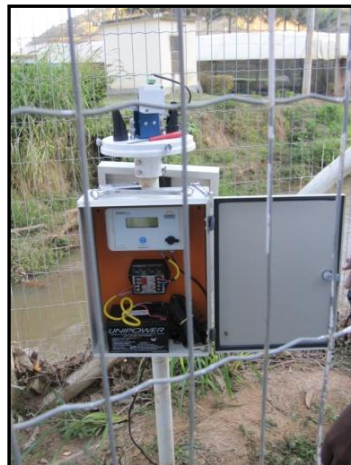
Figura 5.6 – Pluviômetro com dispositivo de datalogger instalado na estação baixo curso.
