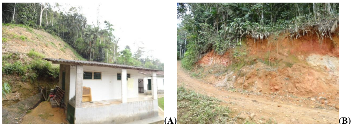
Figura 37: Construção irregular em encosta (A); Talude exposto após corte de estrada (B). Foto: Leonardo S. Pereira (Outubro de 2014).
