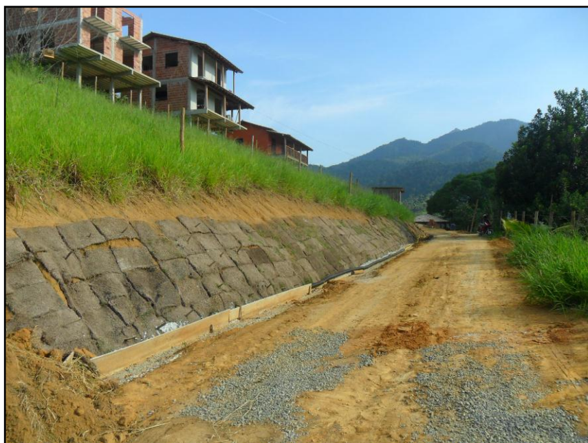
Figura 39. Avanço urbano na bacia hidrográfica do rio Mateus Nunes. Detalhe para a pequena contenção de encosta (Foto: Sara Neves, 2014).
