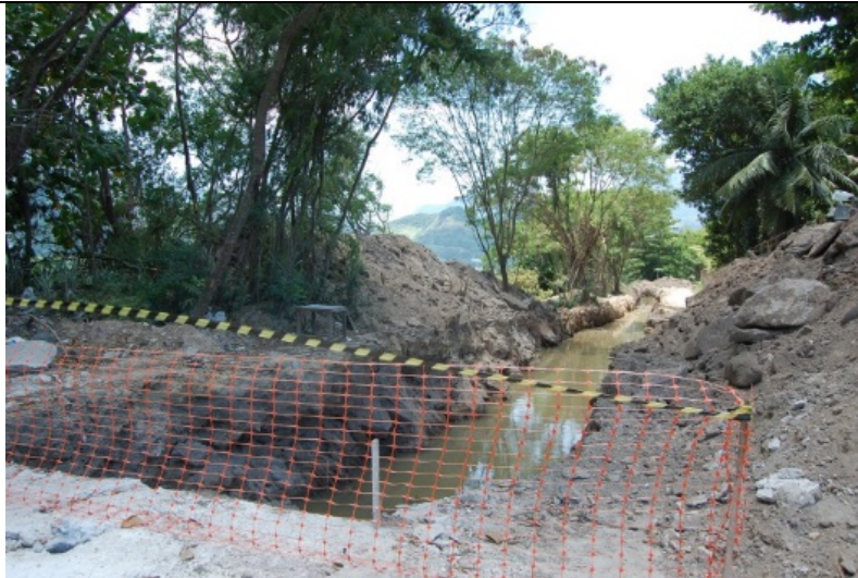
Área adjacente ao supermercado Carrefour, construções de canais a metros da faixa marginal
