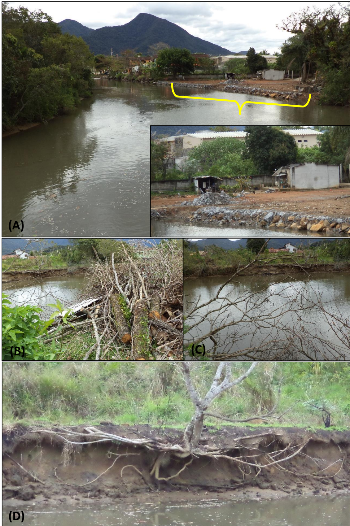
Figura 27. Ocupação desordenada do rio Maranduba (A); retirada da mata ciliar (B); margens erodidas e solapadas, árvores inclinadas e raízes expostas salientando a degradação do rio (C) e (D). Fotos: Aline M. Rodrigues (2015).
