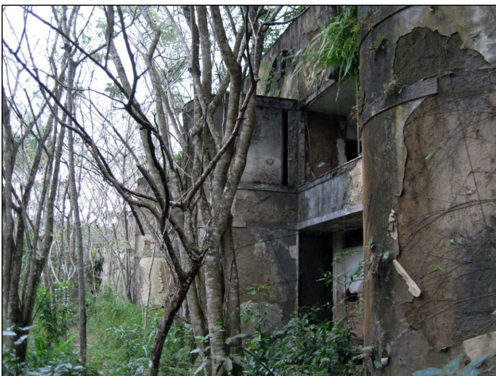
Figura 37: Ruínas no condomínio Bracuí. Fotografia: T. M. Silva (Julho/2011).
