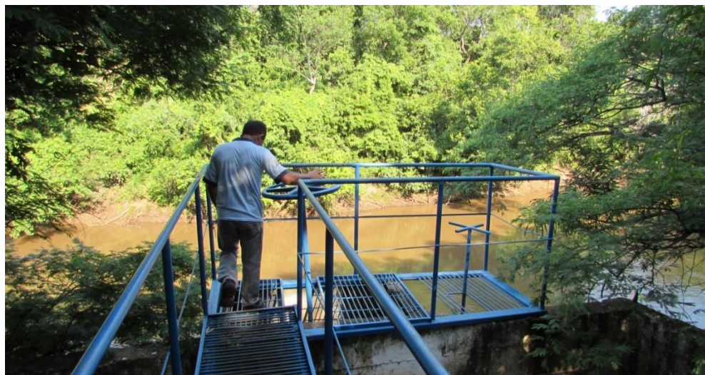
Foto 3: CAPTAÇÃO DE ÁGUA NO RIO APA PARA O ABASTECIMENTO DE BELA VISTA (MS) Foto: L.P. Batista da Silva, novembro 2015
