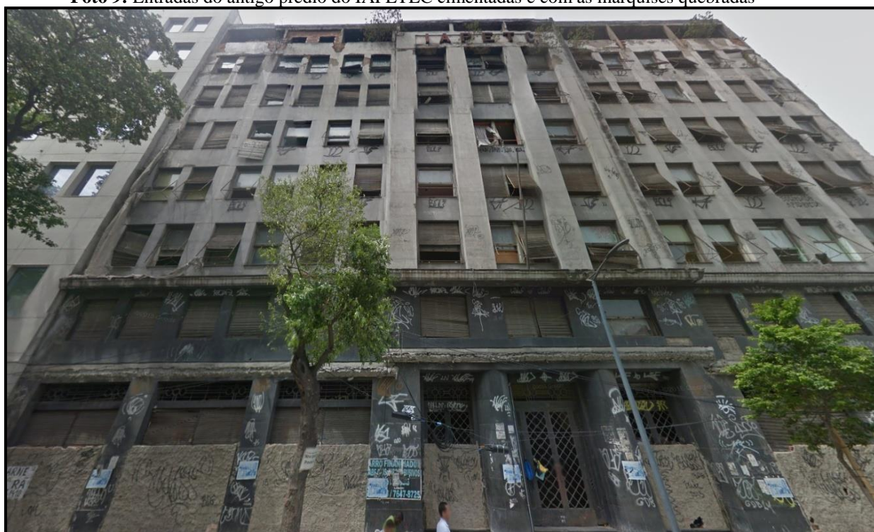
Foto 9: Entradas do antigo prédio do IAPETEC cimentadas e com as marquises quebradas
