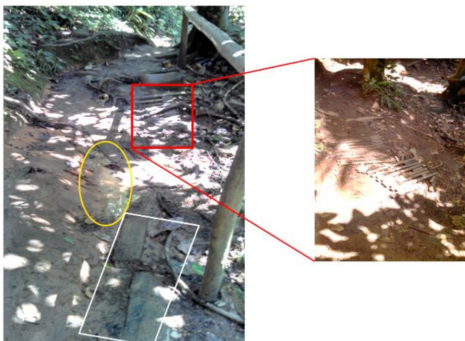
Figura 37. Exemplo de estruturas de manejo degradadas (destaque em vermelho e branco) e pontos de alagamento (em amarelo) na trilha PNC. Fotos: L. A. Rangel (2015).
