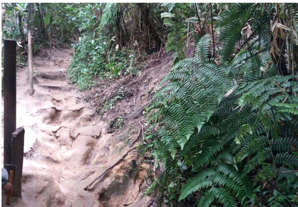
Figura 20. Deslizamento no talude superior do ponto 2, na trilha PMC. Foto: L. A. Rangel (2017)
