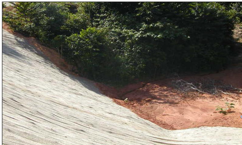
Figura 11.4.1: Manta antierosiva de juta.
