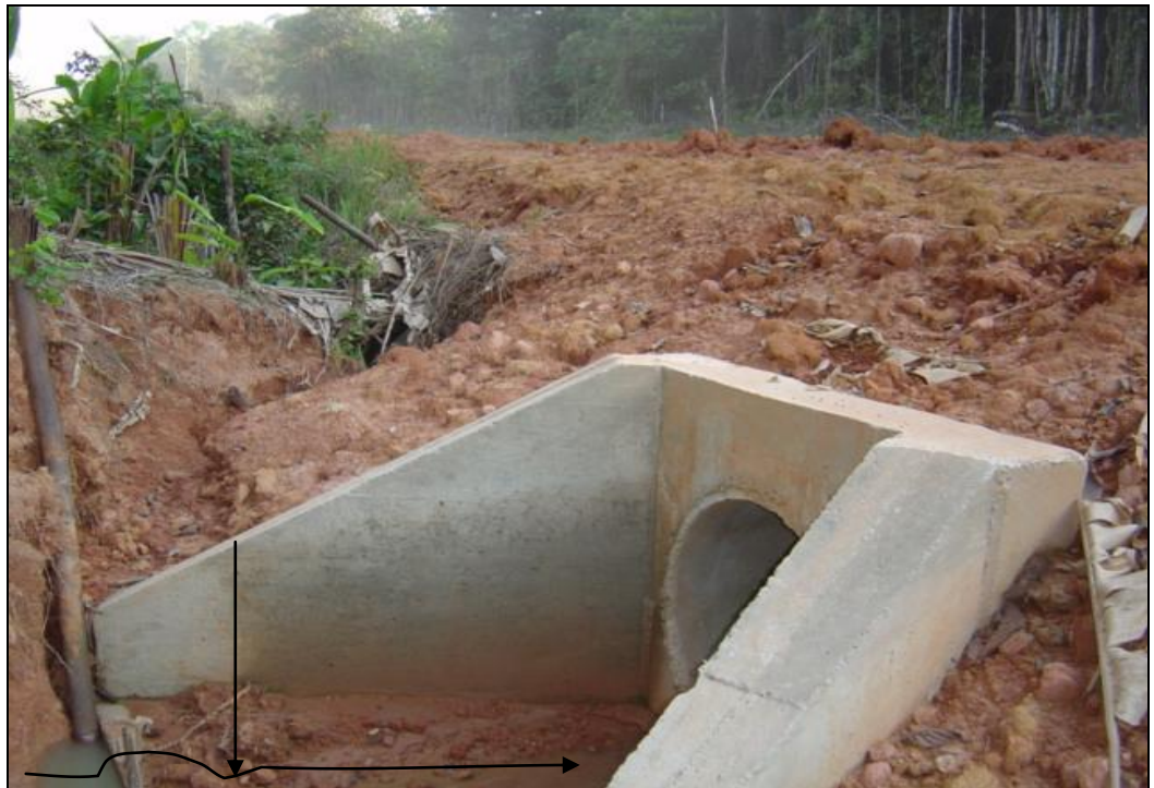
Figura 5.4: Manilha comumente utilizada para a canalização dos cursos de água durante a construção de estradas. Para evitar este tipo de situação a recuperação da área deve ser realizada de modo simultâneo à construção de estradas.
