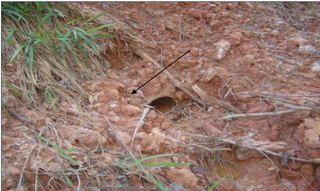
Figura 5.6: Manilha de 1m de diâmetro totalmente obstruída por sedimentos que são transportados da estrada. A ausência de canaletas que evitariam a concentração de fluxos é a principal causa deste processo. Ver figura anterior (nº 5.3) onde a existência de canaleta no nível de base do canal foi insuficiente para evitar a obstrução do mesmo. Neste caso, a obra de contenção de fluxos deverá ser refeita, tanto nas encostas como na parte interna dos pequenos cursos de água que cortam as estradas.
