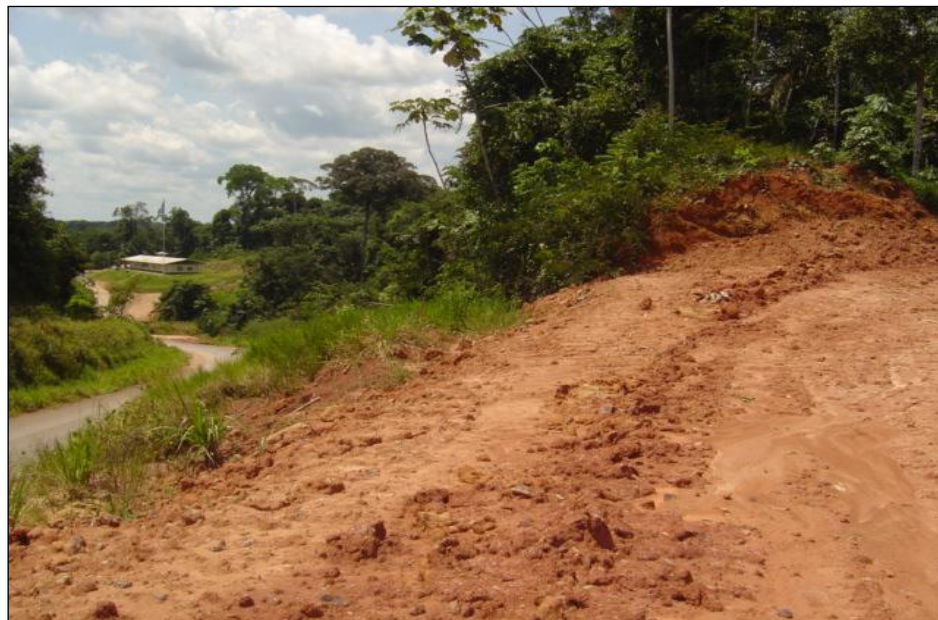
Figura 12.4: As encostas que sofrem ação de corte ou terraplanagens não devem permanecer por longo tempo expostas à ação erosiva.
