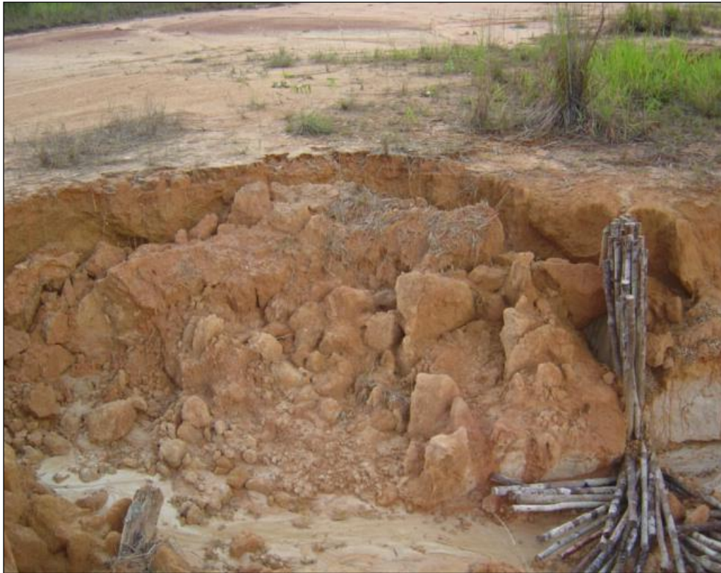
Figura 5.10: Colapso de material existente nas áreas de cabeceiras de voçorocas. As superfícies compactadas nas bordas favoreceram o aparecimento de escoamentos concentrados. A associação de uma rede de fluxos tanto superficiais como subsuperficiais favoreceram a evolução deste tipo de incisão. As barras de madeira à direita colocadas como alternativa de contenção aos desbarrancamentos não foram suficientes para conter a erosão.
