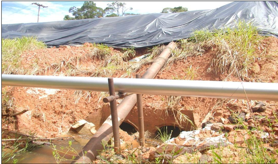
Figura 5.15: Observar a falência deste tipo de obra para a canalização de fluxos em estradas. A quantidade de sedimentos que se distribui nas encostas próximas às estradas e às margens dos canais exerce sobrecarga rompendo as caixas de sustentação das manilhas. As lonas sobrepostas no topo auxiliam a retenção de sedimentos nos períodos de concentração pluvial.
