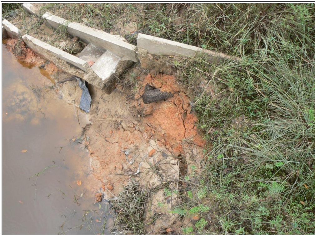
Figura 12.15: Queda de canaleta por erosão marginal. Foto: Bessa (2007)
