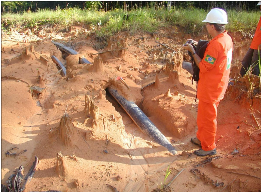
Figura 9.1: O escoamento superficial tem causado a exposição de dutos tanto nas estradas do RUC como do SUC.
