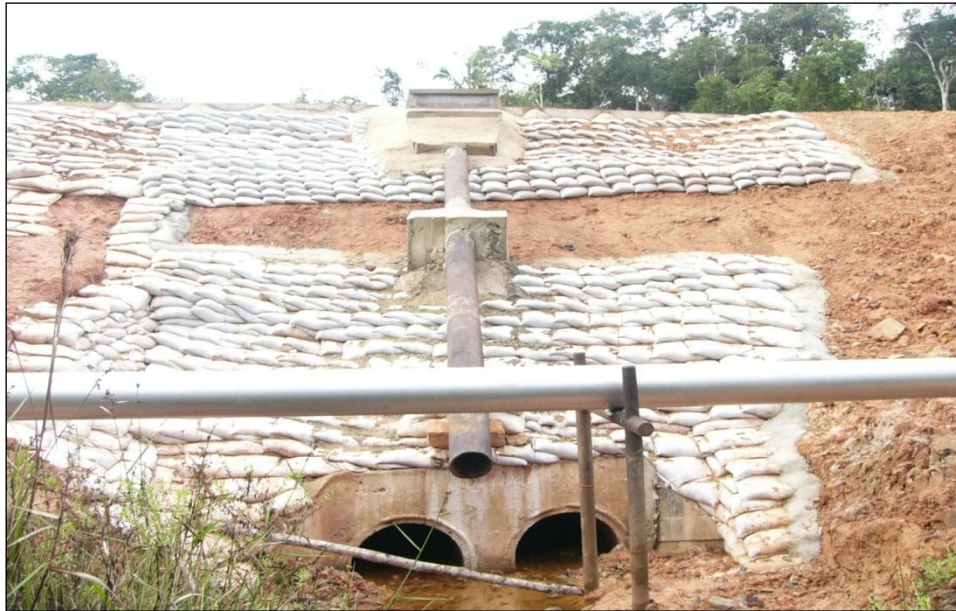
Figura 12.5: Deslizamento de Bolsacreto Foto: Aguiar (2006).
