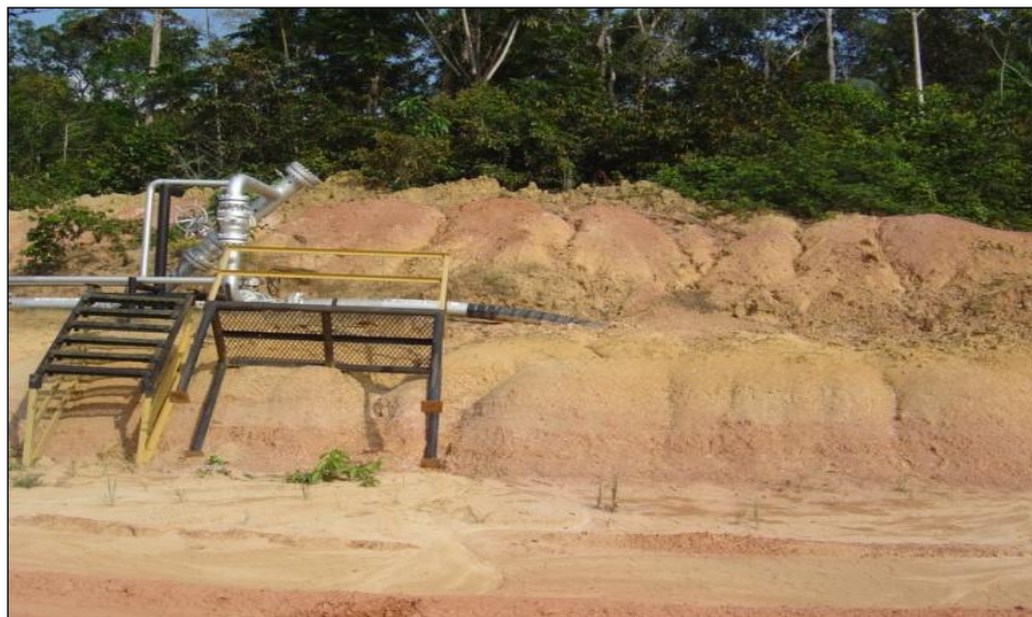
Figura 10.1: A necessidade de escavações para aterro de dutos e a exposição do terreno, a ação de fluxos superficiais propiciou o aparecimento de inúmeros sulcos na parte mais elevada do relevo.
