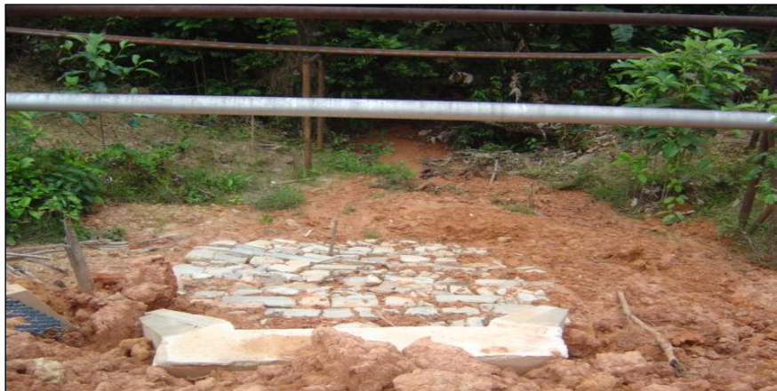
Figura 11.2: Rompimento de aterros. Foto: Aguiar (2005).
