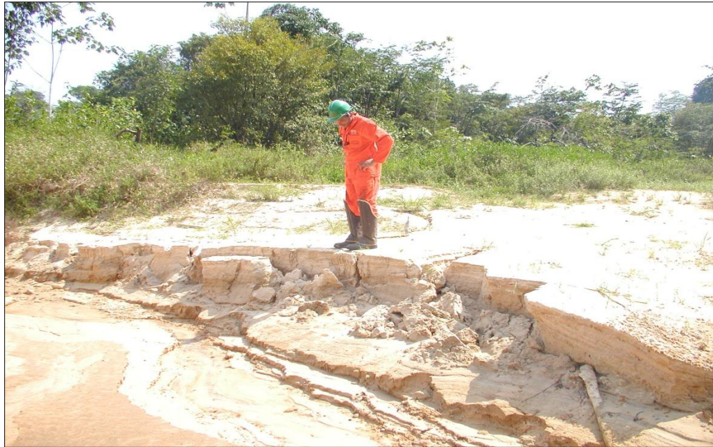
Figura 12.16: Erosão marginal. Foto: Aguiar (2006)
