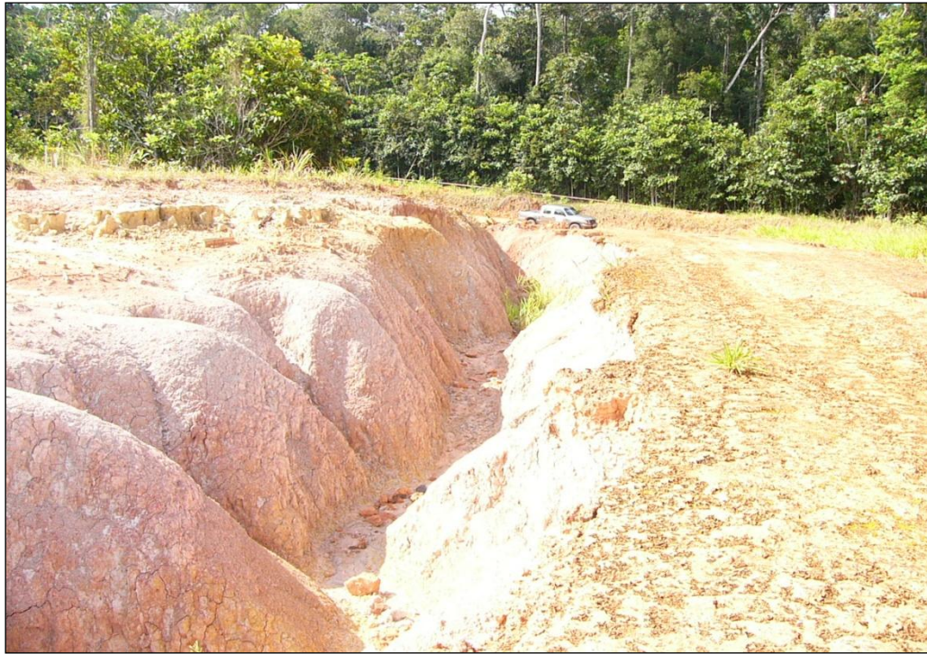
Figura 5.17: Incisão localizada na parte superior do talude. Foto: Aguiar (2004)
