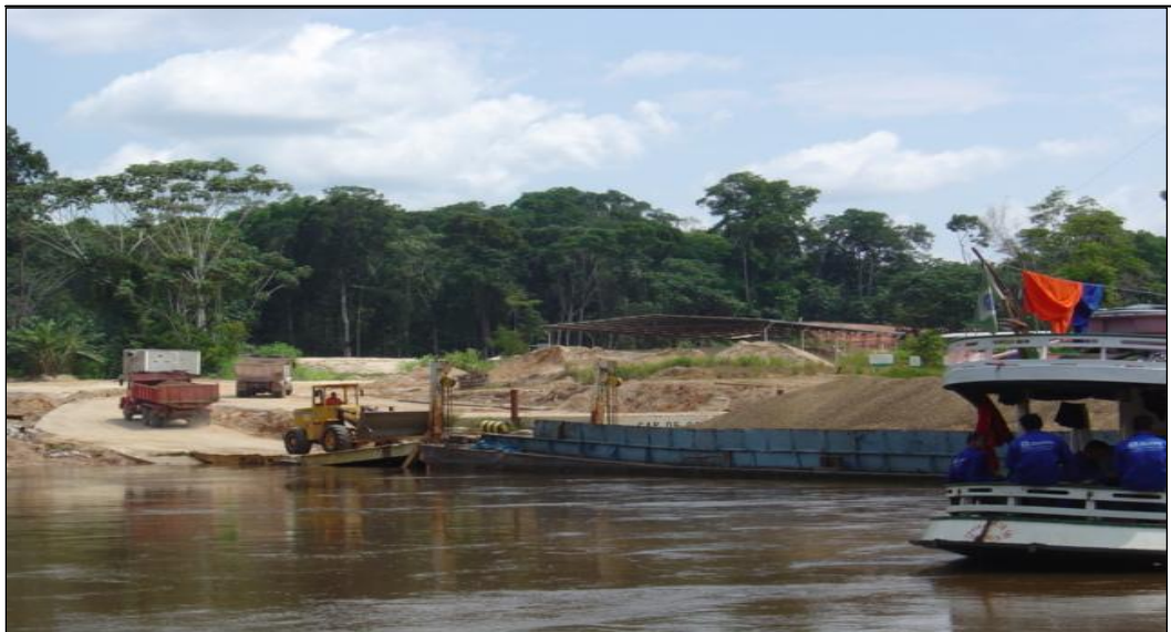
Figura 5.2: Os deslocamentos para transporte de material e o trânsito de máquinas pesadas na Base de Operações são atividades de extrema necessidade. Todavia o processo erosivo torna-se acelerado principalmente nas áreas situadas às margens do Rio Urucu. Foto: Aguiar (2004)
