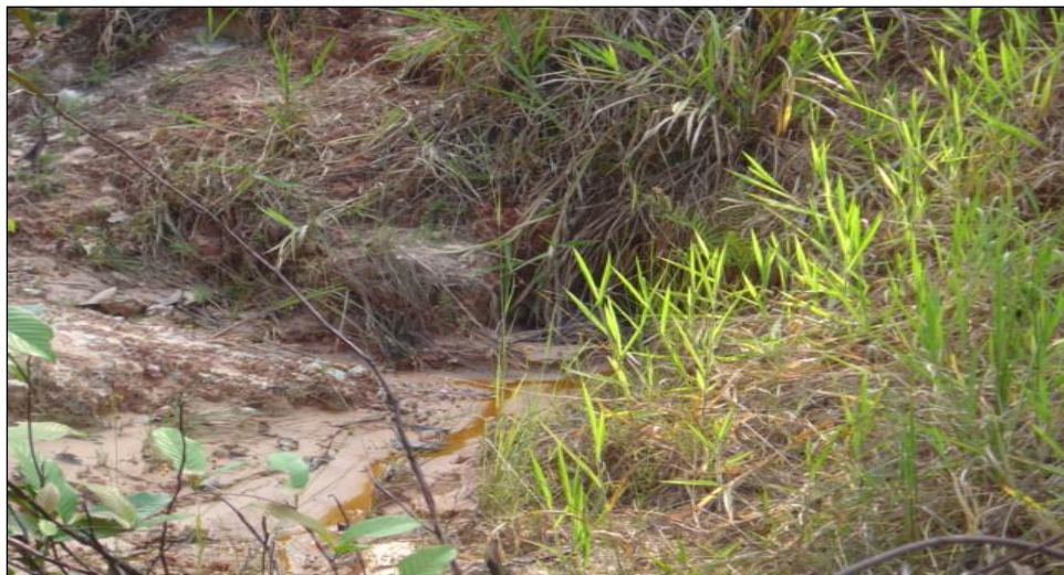
Figura 5.9: A existência de fluxos que se configuram como pequenos canais torna-se uma das principais causas do aumento de erosão na Base de Operações. Estes canais existem por toda a área e apresentam fluxos interrompidos por sedimentos.
