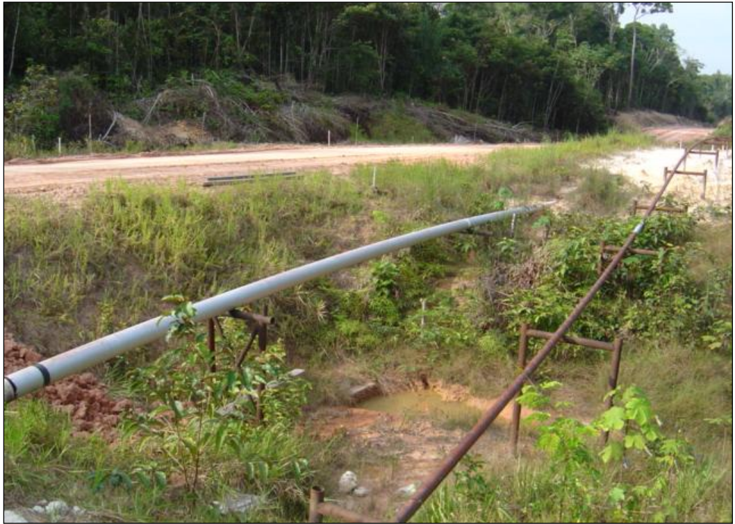
Figura 5.1: Dutos para transporte de gás. Foto: Vieira (2004)
