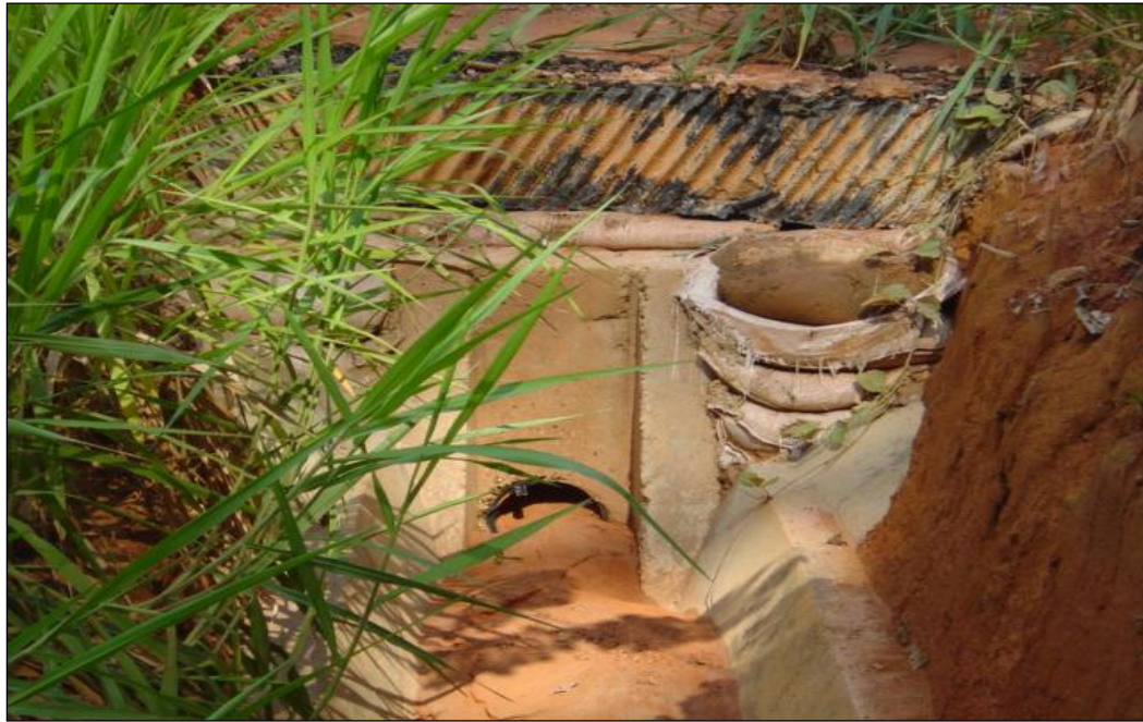
Figura 5.5: O diâmetro das manilhas que drenam canais fluviais da bacia do Rio Urucu se torna subdimensionado. A quantidade de sedimentos transportados por runoff impede a passagem da água por estes dutos.
