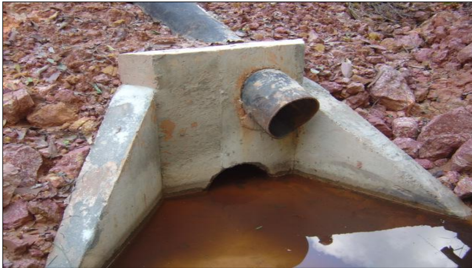
Figura 5.12: Observar o acúmulo de sedimentos na superfície existente na base das caixas de concreto das manilhas. Uma das alternativas para evitar esse tipo de situação seria a elevação do nível da base destas caixas.
