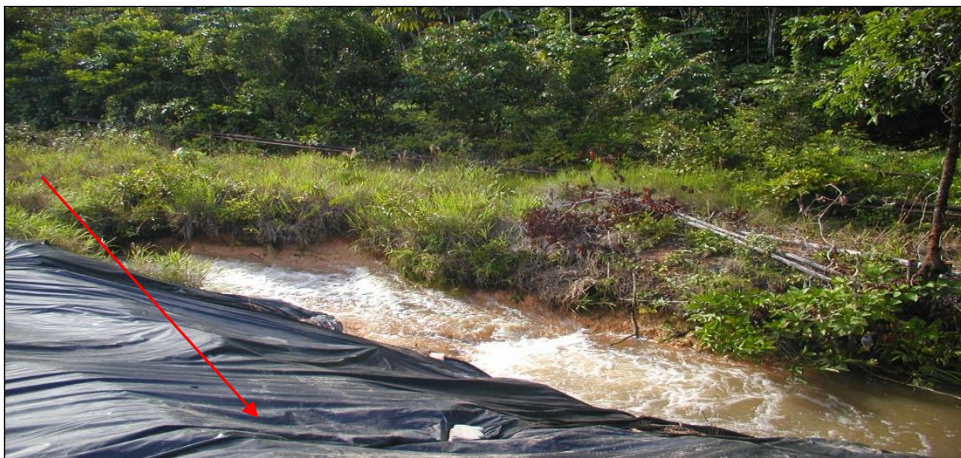
Figura 5.16: A sobreposição de lonas auxilia apenas a retenção de fluxos no topo. Todavia, as concentrações de fluxos na lateral da estrada extravasam a dimensão das canaletas, ocasionando a entrada de água nas faixas próximas às margens.
