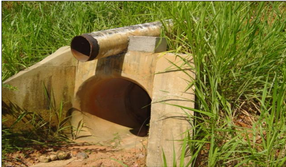
Figura 5.11: O papel dos dutos posicionados na parte superior das manilhas é capturar a água concentrada nas canaletas. Entretanto, este tipo de obra, durante a estação chuvosa, tem ocasionado a escavação do leito e transbordamento de água e sedimentos que levam à situação exposta na figura seguinte.
