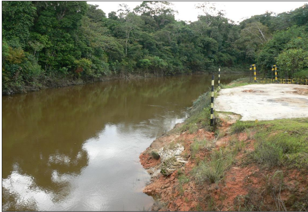
Figura 12.14: Erosão marginal. Foto: Aguiar (2006)
