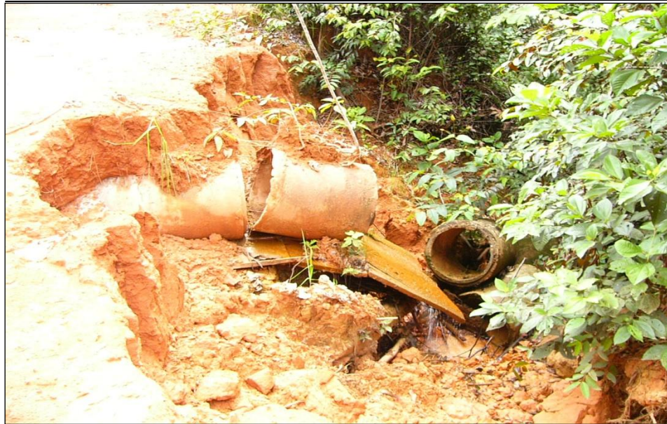
Figura 10.2: Os dutos, que são enterrados no solo com o objetivo de confinar os fluxos para a passagem e abertura de estradas acabam apresentando subdimensionamento de diâmetro causado pela elevação de nível da água e da grande quantidade de sedimentos que são carreados para dentro do canal.
