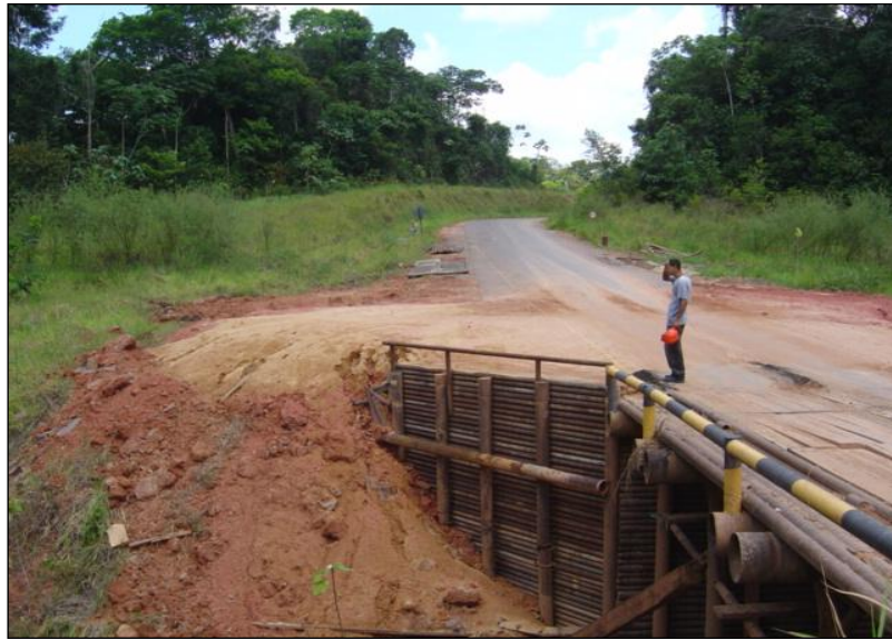
Figura 11.1: Encosta conectada ao canal hidrográfico. Os setores a montante e a jusante desta encosta, não receberam aplicação de nenhuma medida preventiva para reduzir a a velocidade dos fluxos e a contribuição sedimentar sobre os canais. Verificar o surgimento de incisões na parte superior.
