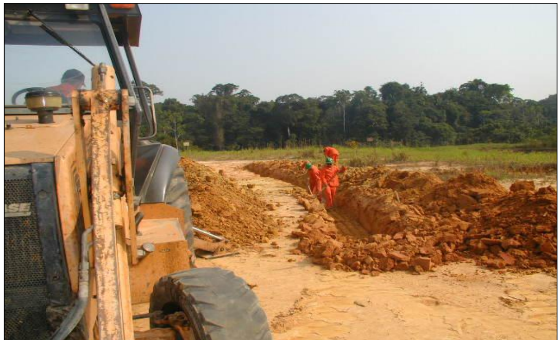
Figura 7.14: Para a perfuração do solo neste local foi utilizado o trabalho mecânico de uma retroscavadeira devido os níveis de compactação.
