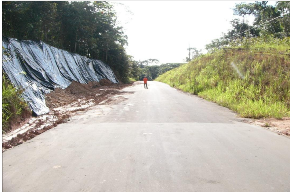
Figura 12.3: Mantas de lona recobrindo encostas. A aplicação de medida mitigadora executada de forma conjunta com a obra reduziria custos de recuperação.
