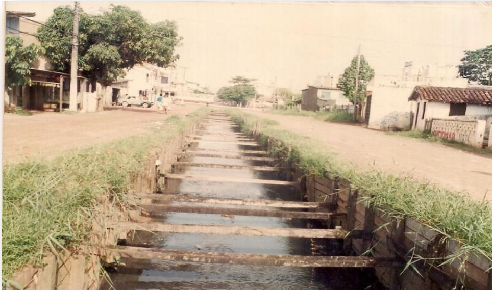
Figura 53 - Estaqueamento de madeira do canal da Angustura, Bacia do Tucunduba e aterramento das margens.
