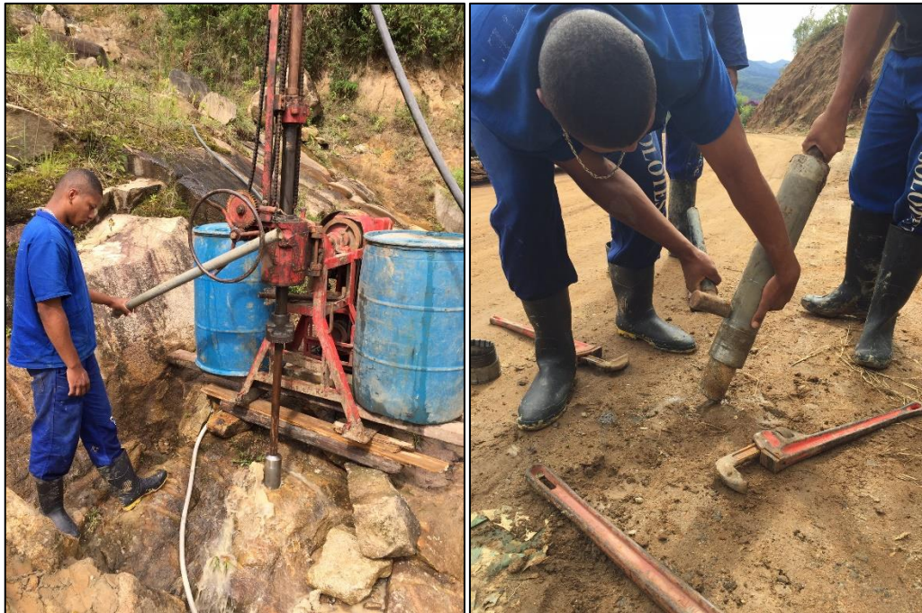
Figura 30: Procedimentos realizados na sondagem rotativa: perfuração (à esquerda) e retirada do testemunho (à direita).
