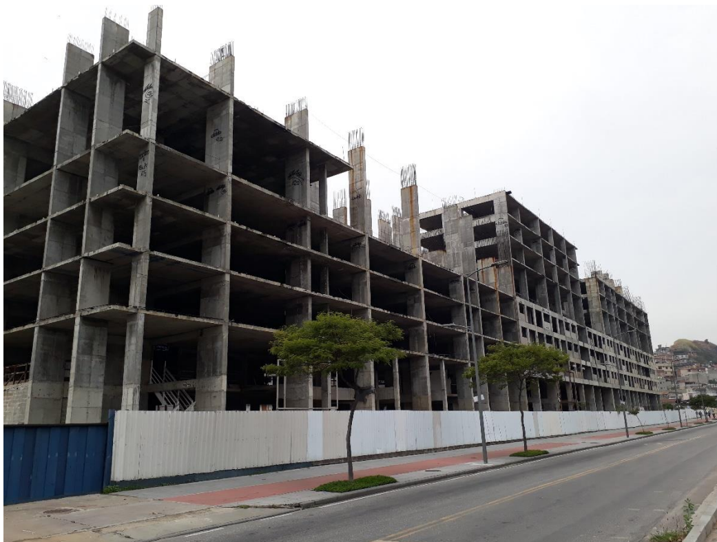
Fotos 32 e 33: Ruínas do Porto Vida Residencial e outra obra abandonada ao lado – Santo Cristo, Rio de Janeiro
