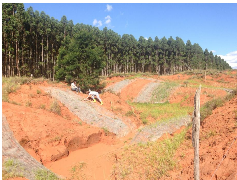
Figura 130. Setor com ravinas desconectadas da rede de drenagem sobre o qual foi instalada a AE-II. Foto: C.L. Vieira (Março, 2016).
