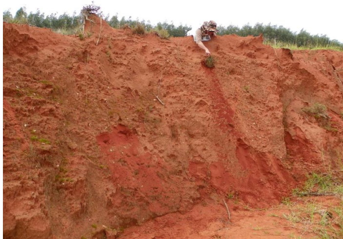
Figura 44. Talude da feição erosiva selecionada, localizada de modo adjacente a um grande monocultivo de eucalipto ( Eucalyptus sp.). Foto: C.L. Vieira (Maio, 2014).
