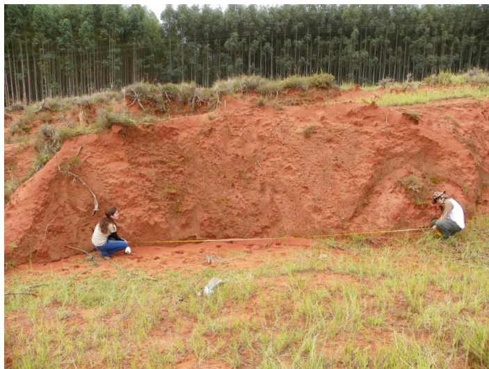
Figura 46. Aferimento de porção do talude para intervenção preliminar. Foto: C.L. Vieira (Maio, 2014).
