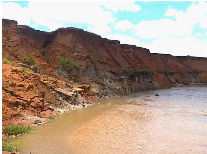
Figura 52. Margem esquerda do talude fluvial da ‘Sanga do Rolador’, sentido montante-jusante. Foto: C.L.Vieira (Dezembro, 2015).
