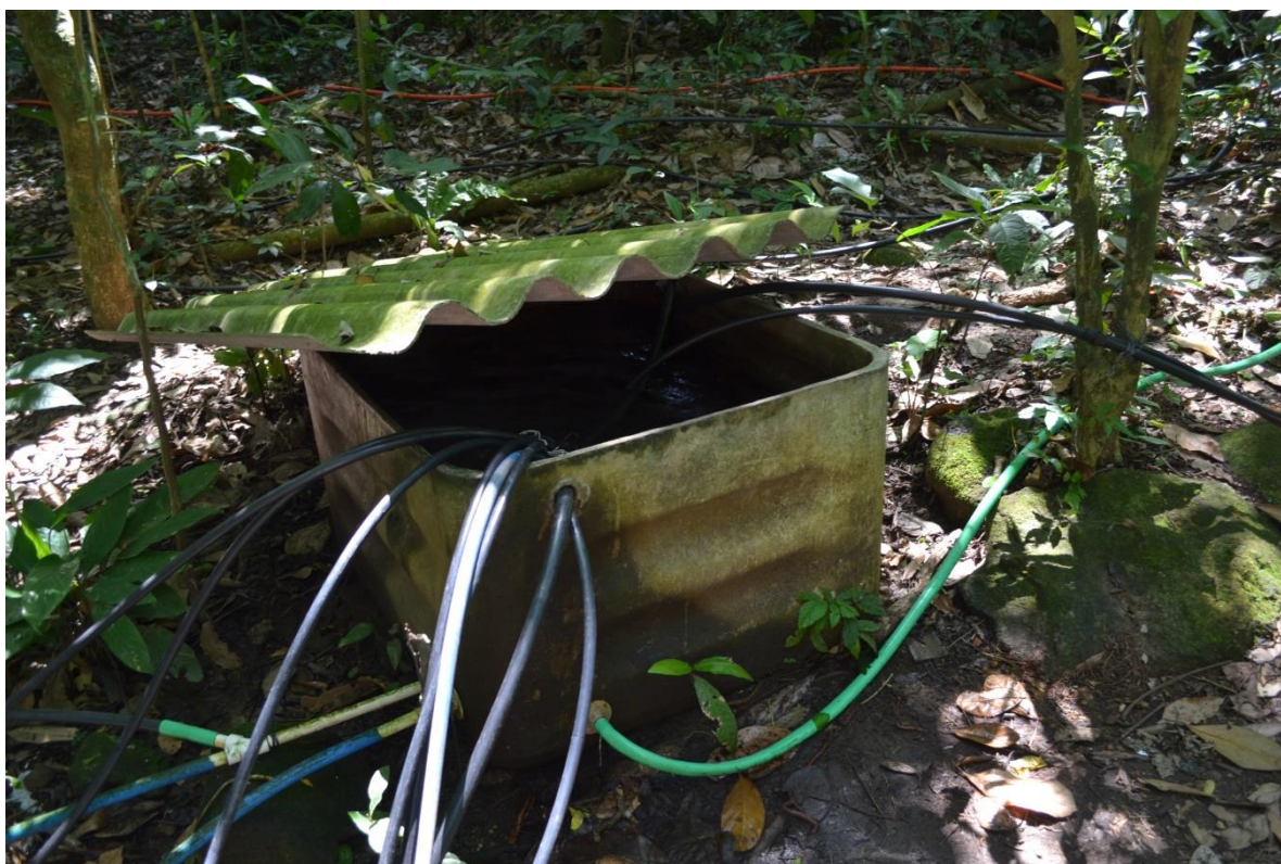
Figura 12 – Captação de nascente na favela Mata Machado. Foto: Eduardo Bayer Knopman (2015).
