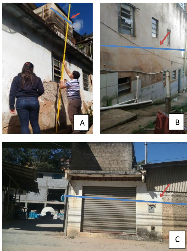
Figura 8. Fotografias em campo (A - Medindo altura nível d'água. B e C - Edificação com marca de altura do nível d'água alcançado).
