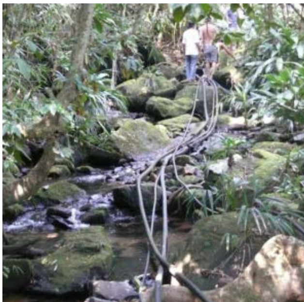
Figura 25– Instalação chamada "macarronada", instalação individual que gera desperdício. Fonte: FIOCRUZ, 2016.
