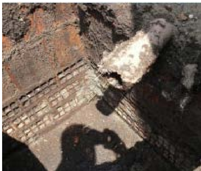
Figura 26 - Caixa de gordura inadequada na praia do Sono. Fonte: FIOCRUZ, 2016
