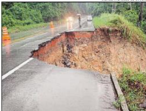
O TRECHO DA Rio-Santos destruído por um deslizamento de terra
