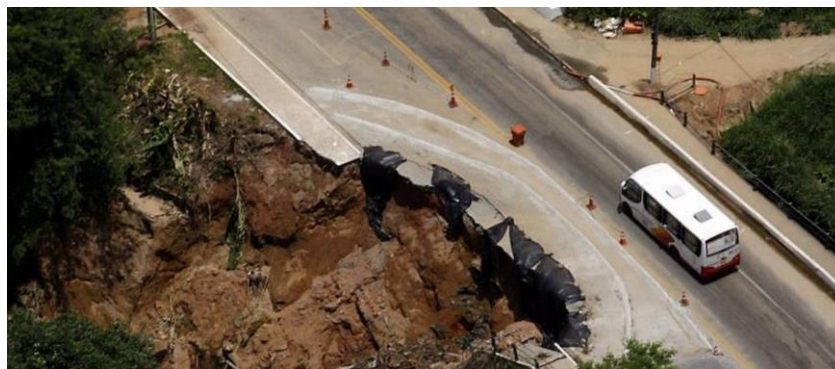
Figura 3: Trecho da BR-101 destruído após a ocorrência de deslizamentos em 08 de Janeiro de 2010. Fonte: https://oglobo.globo.com/rio/apos-deslizamentos-em-angra-coppe-constata-situacao-critica-da-rio-santos-3071601 .
