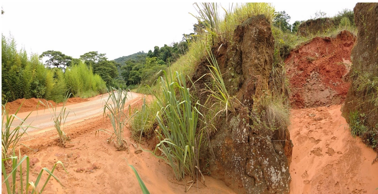
Figura 72 – Foto panorâmica mostra a saída da voçoroca junto à estrada RJ-155/BR-494 com visão impressionante da quantidade de material mobilizado e atrapalhando bastante a segurança da via. A calha de drenagem ficou soterrada. Foto: Diego Janoti Suarez (2018).
