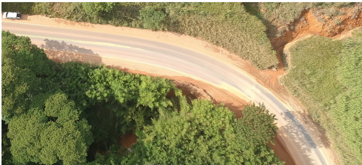
Figura 68 – Grande acúmulo de material erodido em fevereiro se mantém em março de 2018, ao longo das áreas de acostamento e de parte da pista próximo à saída da voçoroca. No canto superior esquerdo, Fiat Dobló da UFRJ serve de escala. Foto: Fabrizio Garritano (2018).
