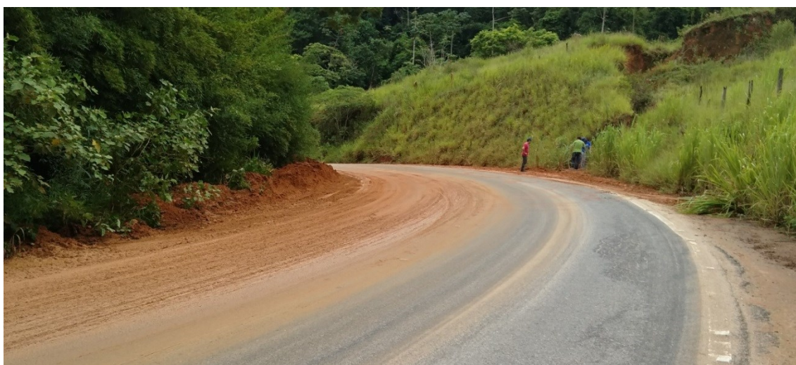
Figura 70 – Faixa de rolamento no sentido Angra dos Reis completamente coberta por solo erodido da voçoroca A e acúmulo nos acostamentos. Foto: Diego Janoti Suarez (2018).
