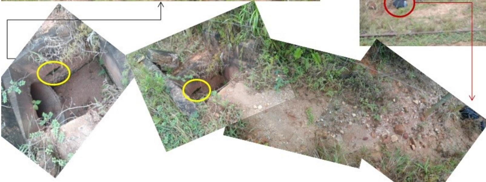
Figura 55 – Água e sedimentos saem da voçoroca B em direção à calha de águas pluviais. Esta drena para a parte inferior da encosta, abaixo dos trilhos, onde uma voçoroca se formou por esta falha do sistema de drenagem pluvial. No detalhe, em vermelho, mochila preta auxilia na orientação das imagens e em amarelo destaca-se um ponto de referência no interior da calha. Fotos: Hugo Alves S. Loureiro (2016).
