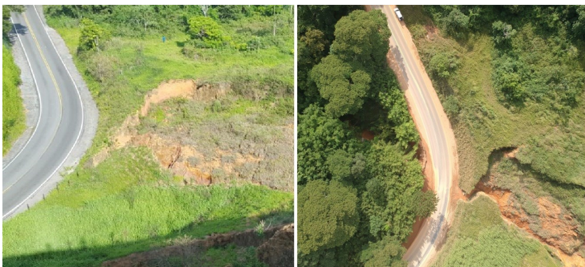
Figura 69 – Voçoroca A e RJ-155/BR-494 em dezembro de 2017 (à esquerda) e março de 2018 (à direita). Foto: Fabrizio Garritano (2017 e 2018).
