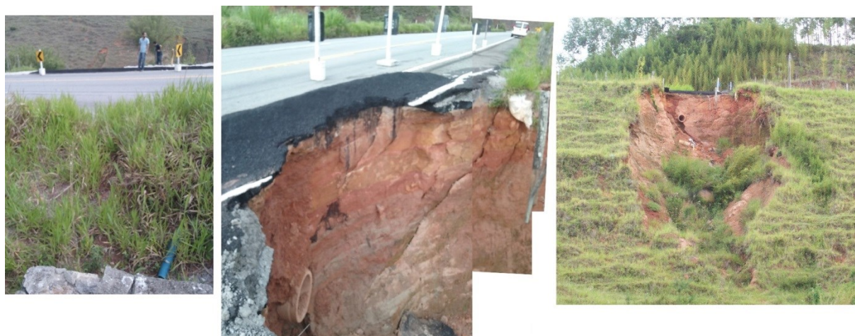
Figura 57 – Voçoroca E prejudicando a estrada e gerando risco à segurança. Problema grave do sistema de drenagem da estrada em talude de aterro. À esquerda, na parte inferior da foto, a entrada da calha de um lado da estrada leva ao outro lado, com saída na voçoroca. Fotos: Hugo Alves S. Loureiro (2016 e 2017).
