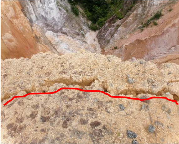
Figura 57: Fenda de tração na borda da voçoroca 01. Em vermelho o destaque do contorno da fenda, bairro Distrito Industrial II. Fonte: Armando Brito da Frota Filho, 2018.
