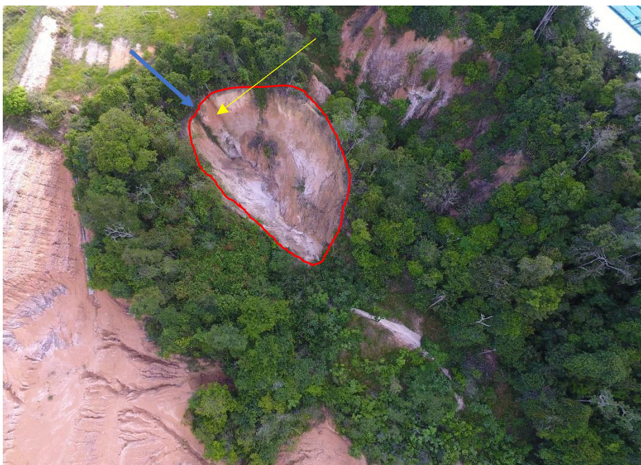
Figura 50: Voçoroca localizada no bairro Distrito Industrial II, em contorno vermelho, seta azul indica a direção da canaleta, seta em amarelo indica saída da canaleta. Fonte: Fábio Vieira e Armando Brito da Frota Filho, 2018
