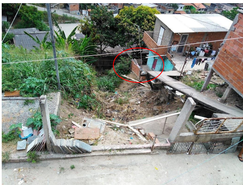
Figura 5.30: Detalhe para o ponto de deslizamento. Localidade plenamente ocupada, ponto segundo os moradores de confluência de água, apresentando acúmulo de lixo e vegetação. Em destaque encanamento voltados para ponto do deslizamento
