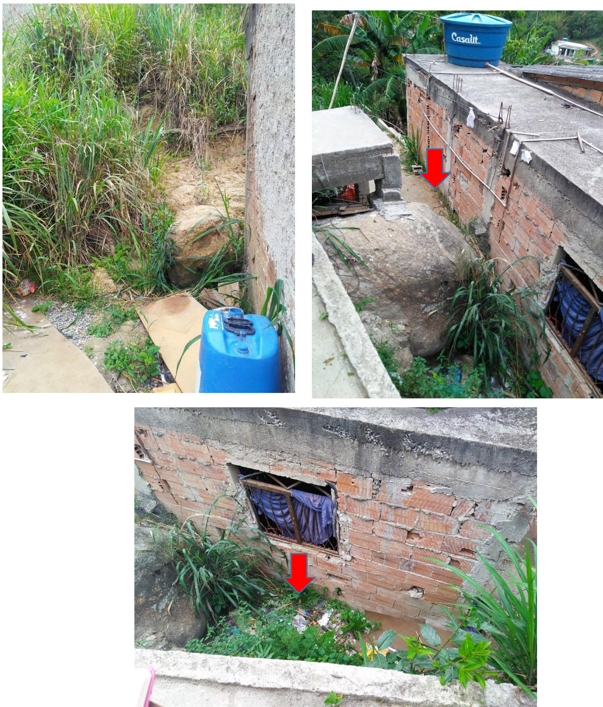
Figura 5.40: Detalhe do padrão construtivo, do acúmulo de resíduos e da rocha muito próxima a residência.
