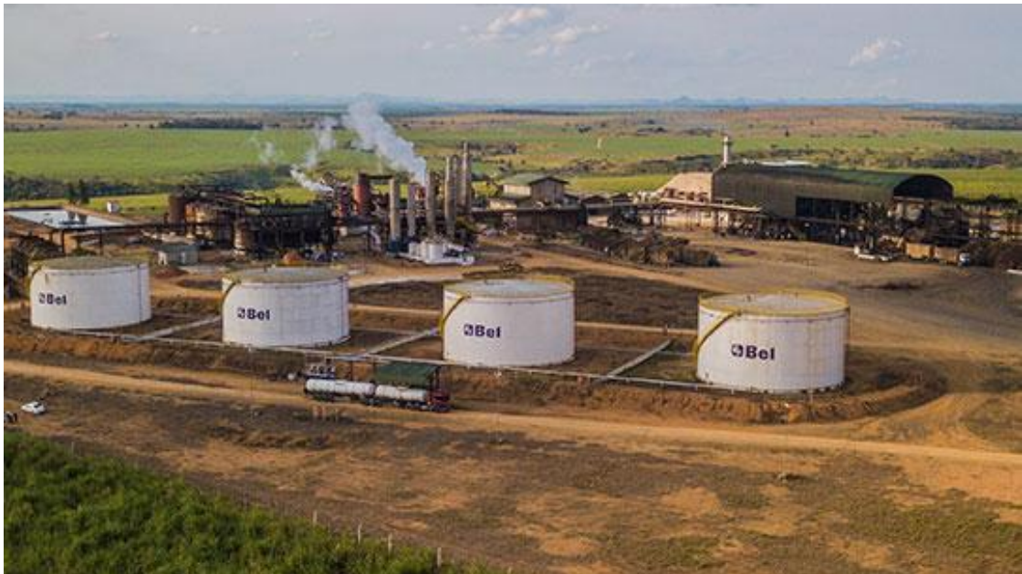
Figura 13 - Tanques de armazenagem de etanol da UAS Bahia Etanol
