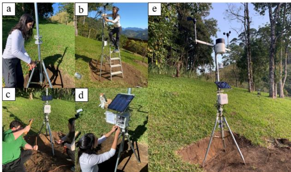
Figura 31. Instalação da estação meteorológica: a) nivelamento do mastro de ferro; b) orientação do sensor de direção do vento para norte; c) instalação do fio-terra (para-raios); d) conexão dos sensores; e) visão geral da estação meteorológica.
