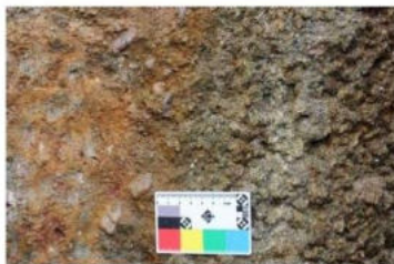
Figura 6. Contato entre a camada intermediária síltico-argilosa a esquerda e a rocha alterada a direita. Foto: Felipe Waldherr, Dez./2021.
