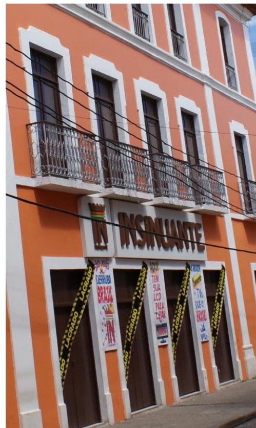
Figura 115 – Fachada com engenho publicitário fora das Diretrizes do IPHAN.
