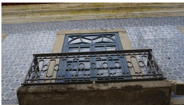
Figura 106 – Balcão do imóvel 15, quadra 01A.
