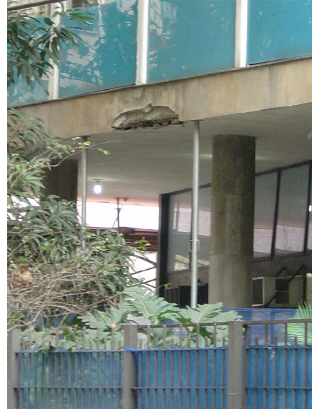
Fig.294– Ruptura da placa de arenito na fachada sul do edifício Nova Cintra
