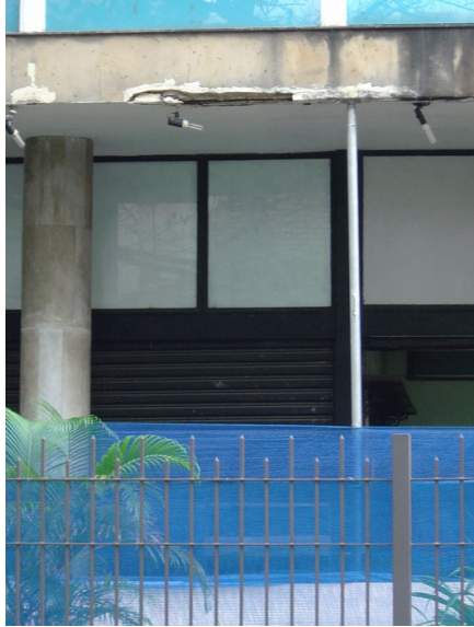
Fig. 293 – Fissuras nas placas de arenito da fachada sul do edifício Nova Cintra
