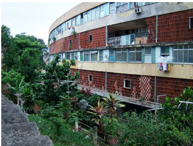
Fig. 195 – Fachada norte do bloco A em avançado estado de degradação
