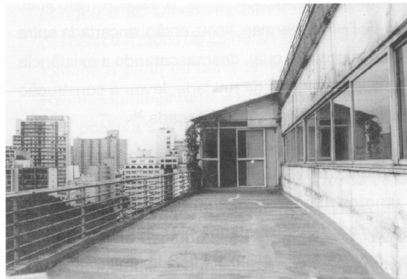
Fig. 206– Alterações na cobertura
