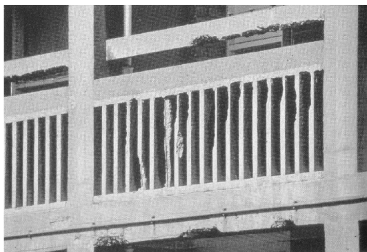
Fig. 166 – Elementos de concreto degradados na fachada do conjunto Park Hill
