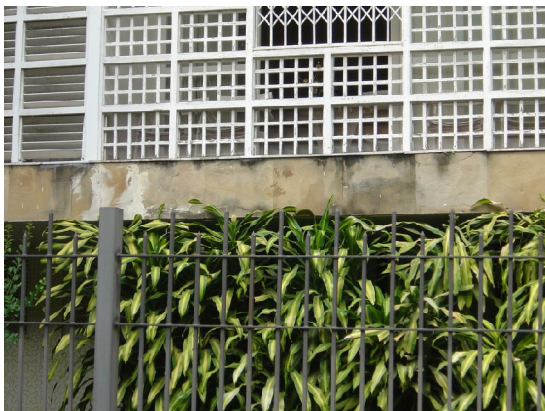
Fig. 285– Placas de concreto e arenito degradadas no edifício Nova Cintra
