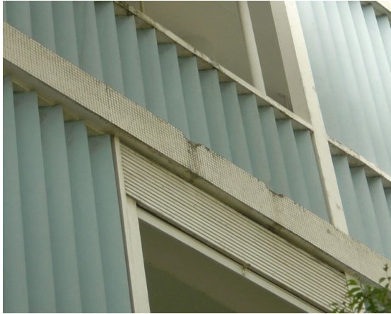
Fig. 283– Perda do revestimento em pastilha da fachada do edifício Bristol
