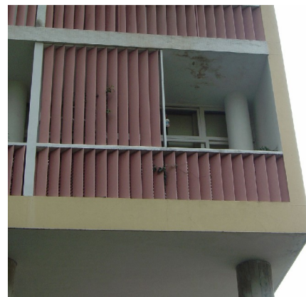
Fig. 296– Infiltração na laje da loggia do edifício Bristol
