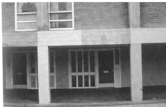
Fig. 167 – Teste de aplicação do novo concreto na fachada do conjunto Park Hill
