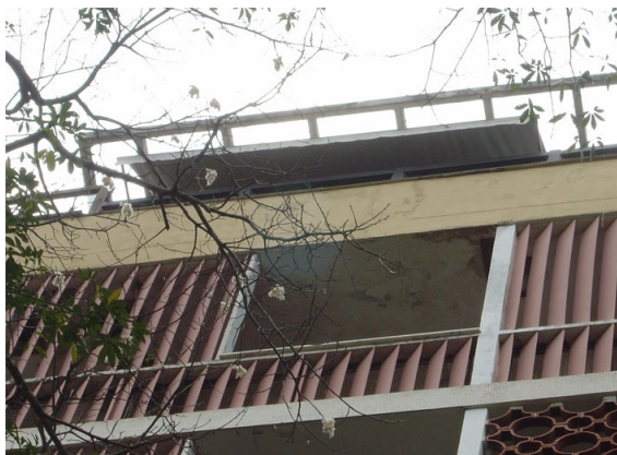
Fig. 295– Infiltração na laje de cobertura do edifício Bristol
