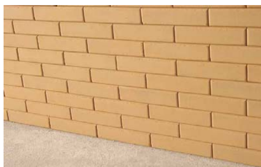
Figura 98 -Superfície lisa e plana: sem reboco e emboço. Fonte: http://www.man.com.br/liminacão_de_casa_economica/liminacão_reboco.htm . Acesso em 02 out.2005.
