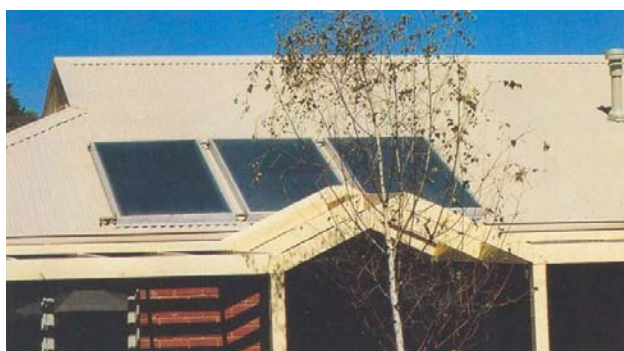
Figura 127 - Coletor solar em residência na Austrália. Fonte: http://www.wignells.com.au/products/solar/Solar%20Pic%203.jpg . Acesso em 27 jan.2006.
