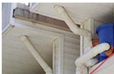
Figura 172 - Calha e tubulação para a coleta da água de chuva. Fonte: USP, 2005.
