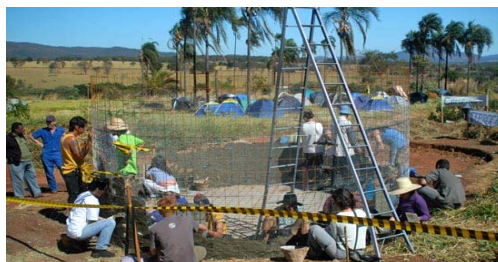
Figura 177 - Construção da cisterna em sistema de mutirão. Fonte: http://www.ecocentro.org/galeria/ferrocimento/index.htm . Acesso em: 15 jan.2005.
