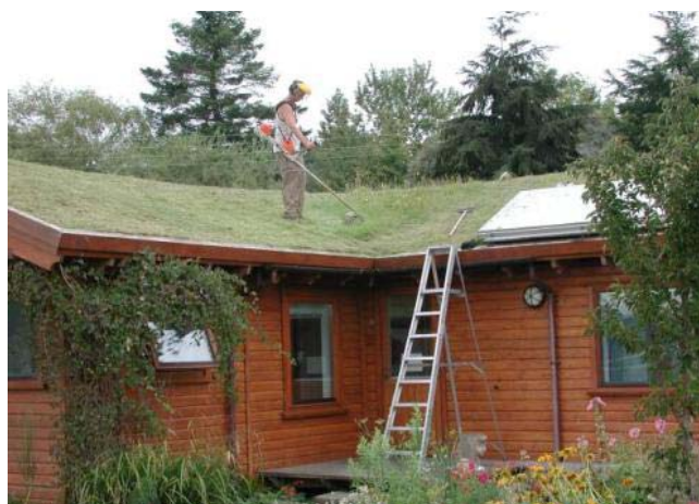
Figura 18 - Manutenção de um telhado verde. Fonte: FINDHORN, 2005.
