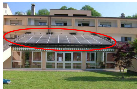
Figura 140 - Telhado em painel fotovoltaico. Fonte: http://www.cansiglio.it/Immagini/varie/Tetto%20fotovoltaico%201.jpg . Acesso em 07 fev.2006.
