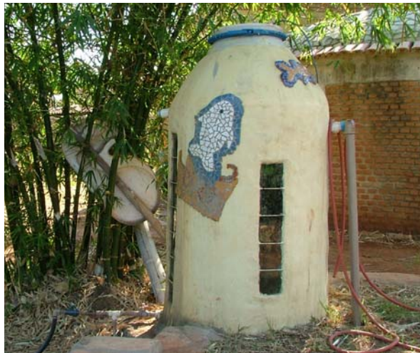
Figura 75- Tanque biodigestor. Fonte: ZUNINO, 2005.
