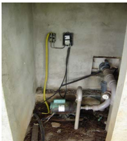
Figura 337 - Detalhe da bomba. Fonte: RAINHO, 2005.
