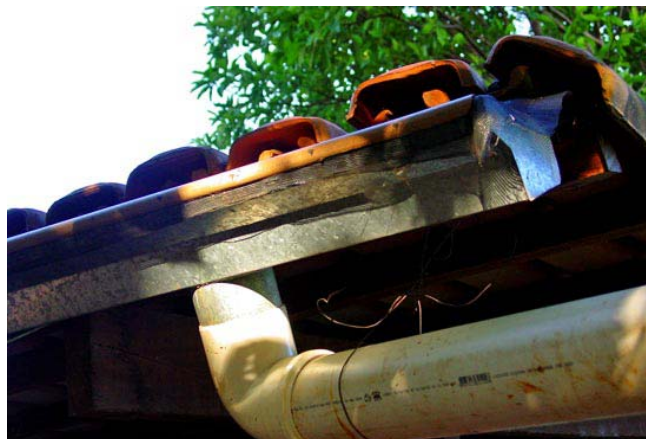
Figura 68- Calha coletora da água de chuva. Fonte: IPEC, 2005.
