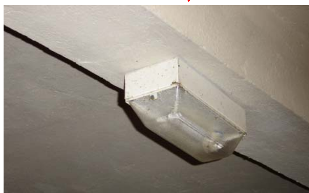
Figura 289 - Detalhe da lâmpada na cozinha. Fonte: RAINHO, 2005.
