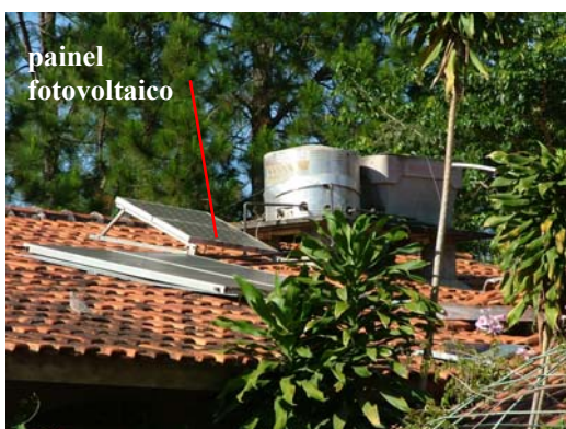
Figura 288 - Painel fotovoltaico da cozinha. Fonte: RAINHO, 2005.
