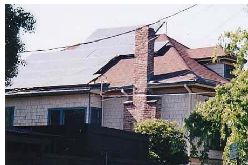
Figura 138 - Painéis em residência - Califórnia, Estados Unidos. Fonte: NOGUEIRA JR, 2005.
