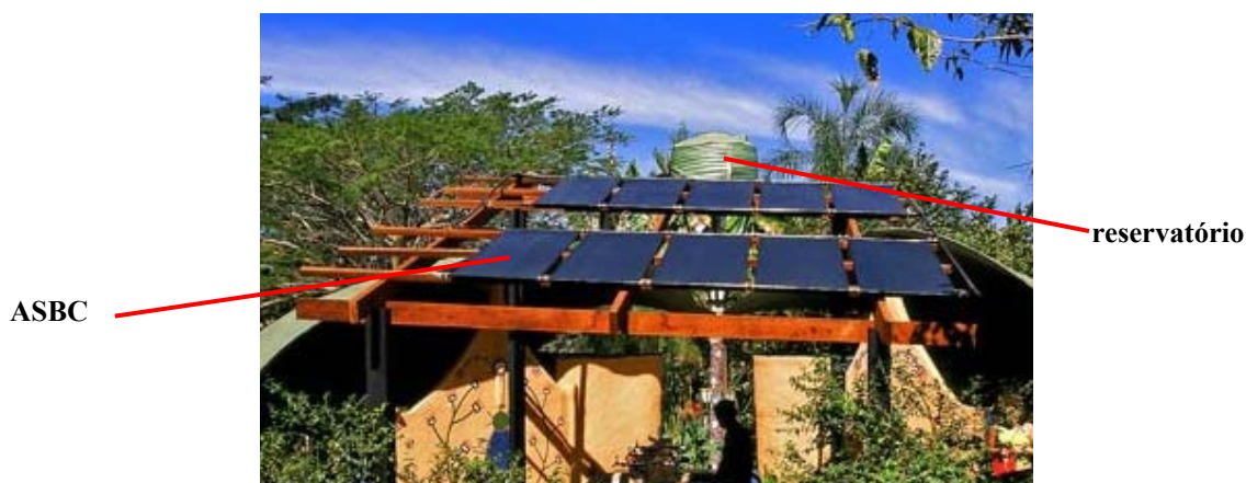
Figura 64- ASBC e reservatório. Fonte: IPEC, 2005.
