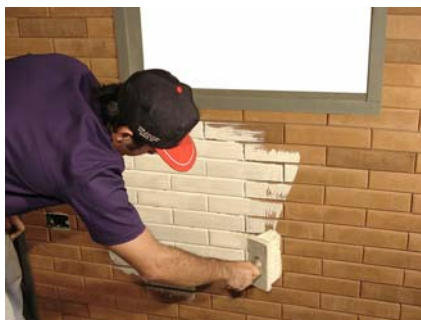
Figura 103 -Pintura das paredes de tijolo de solo-cimento. Fonte: http://www.man.com.br/construcao_de_casa_economica/Pintura_direto.htm . Acesso em 02 out.2005.
