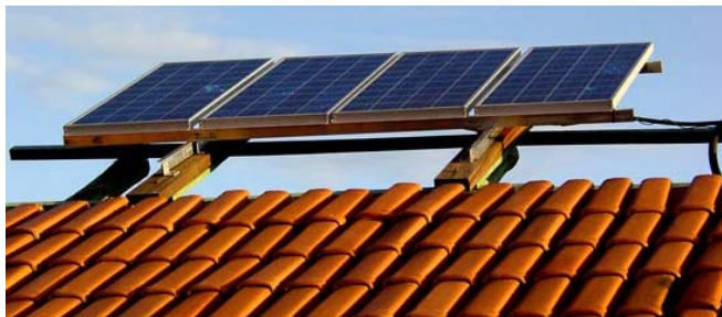
Figura 62- Detalhe do coletor solar fotovoltaico. Fonte: IPEC, 2005.
