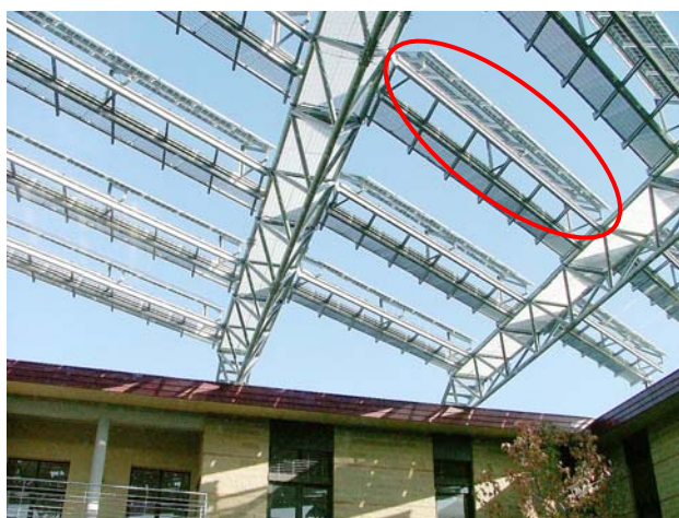
Figura 141 - Cobertura com painéis fotovoltaicos. Fonte: http://met.provincia.fi.it/public/images/Fotovoltaico%2003112004.jpg . Acesso em 07 fev.2006.
