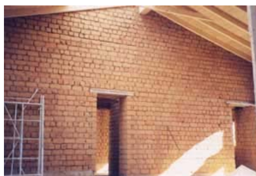
Figura 92 -Detalhe da parede do atelier. Algarve, Portugal. Fonte: http://www.construdobe.com/pt . Acesso em 20 jan.2006.
