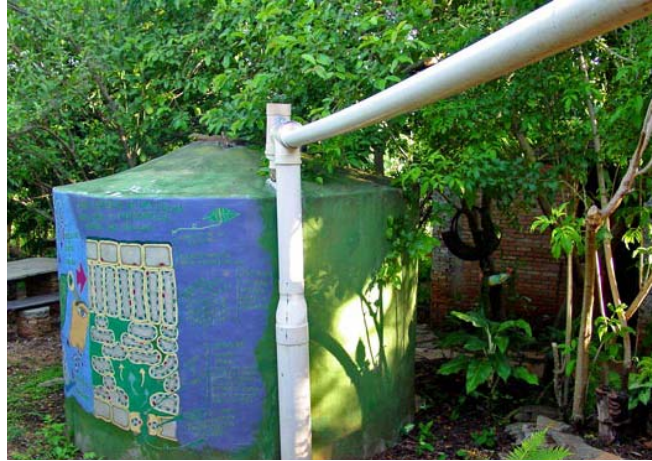
Figura 69- Reservatório em ferrocimento para armazenamento da água coletada. Fonte: IPEC, 2005.
