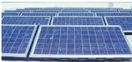
Figura 134 - Painéis fotovoltaicos. Fonte: MEP 62 , 2005, p.11.
