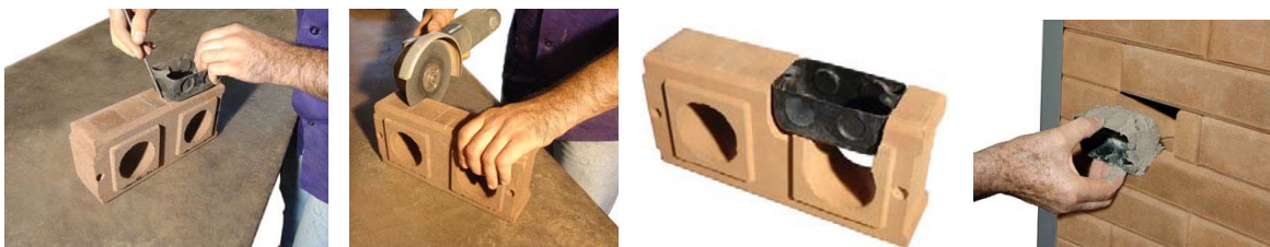
Figura 395 -Passo a passo do encaixe da caixa de tomada no tijolo de solo-cimento.
