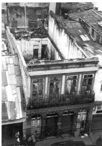
Figura 93 – Cortiço na rua Sacadura Cabral, 295 – Fachada antes da restauração (SECRETARIA, 2000, p. 26).
