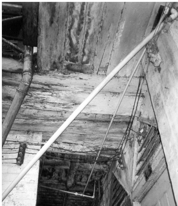
Figura 120 – Infiltrações no forro da circulação externa (RODRIGUEZ, 1996, p. 5).
