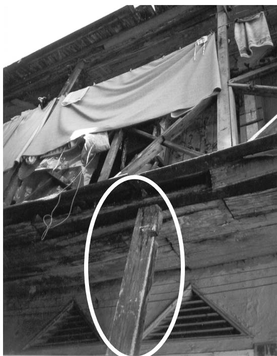
Figura 119 – “Escoramento executado por moradores para a sustentação da circulação externa do pavimento superior” (RODRIGUEZ, 1996, p. 4).
