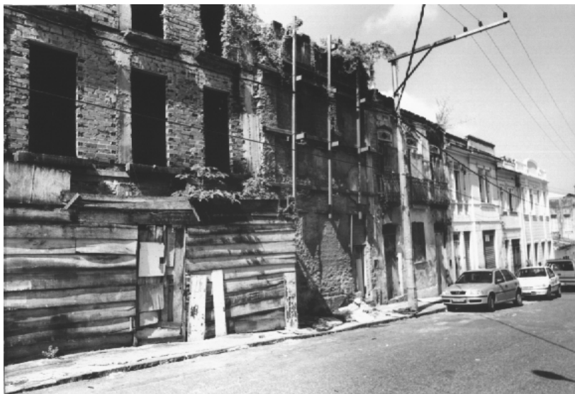
Figura 58 – Outro exemplo de imóvel passível de recuperação para fins habitacionais (CONDER, s.d.b).
