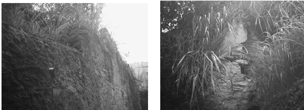
Figuras 189 e 190 – Muro divisório interditado (autora, 2005).
