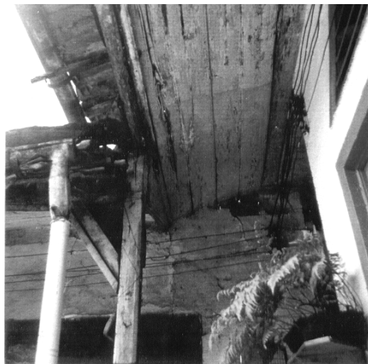
Figura 123 – Estado de conservação do forro da circulação (CEBRIÁN, 1995, p. 32).
