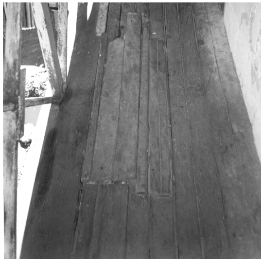
Figura 122 – Estado de conservação do piso da circulação (RODRIGUEZ, 1996, p. 7).
