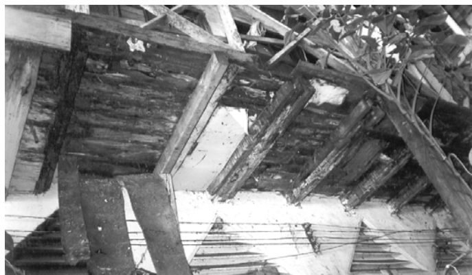
Figura 117 – Barroteamento de madeira – Piso do corredor do segundo pavimento (RODRIGUEZ, 1996, p. 3).
