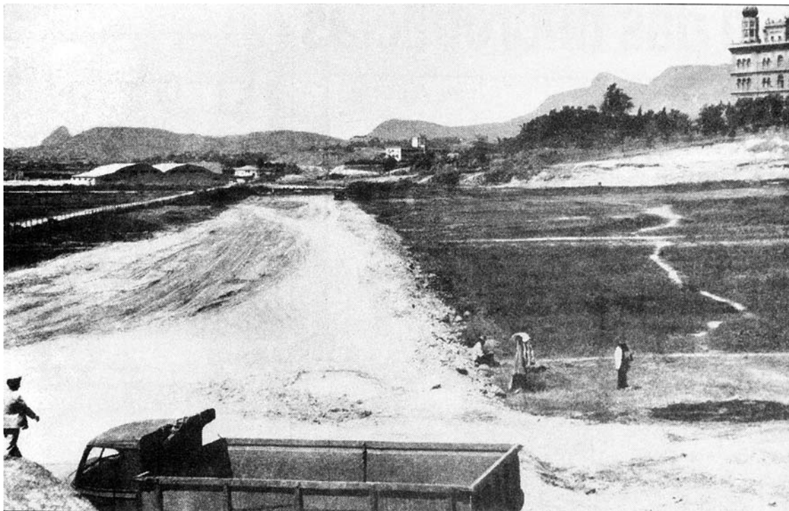
Foto da obra da Avenida Brasil. Revista Municipal de Engenharia , março de 1941. Biblioteca Noronha Santos, IPHAN-RJ.
