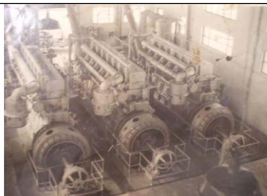
Casa de Força, para atender a Base Naval.
