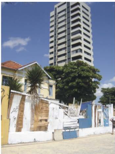
Fig. 109: edificações degradadas e abandonadas no calçadão
