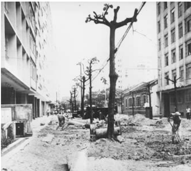
Imagem 99: Retirada das árvores e alargamento da Rua Raul Pompéia para a abertura do Túnel Sá Freire Alvim, c.1959.
