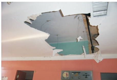
Figura 65 - Rebaixo em gesso danificado na sala de esterilização, no 8º pavimento, que já havia sofrido uma reforma em meados dos anos 90 para a ativação do centro cirúrgico, onde a obra foi concluída porém o centro cirúrgico não veio a funcionar. Fonte: Espaço Saúde, 2003.
