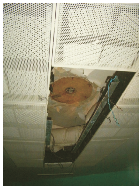
Figura 67 - Instalações elétricas aparentes devido a falta da placa de rebaixo do teto, na circulação do centro cirúrgico no 8º pavimento. Fonte: Espaço Saúde, 2003.
