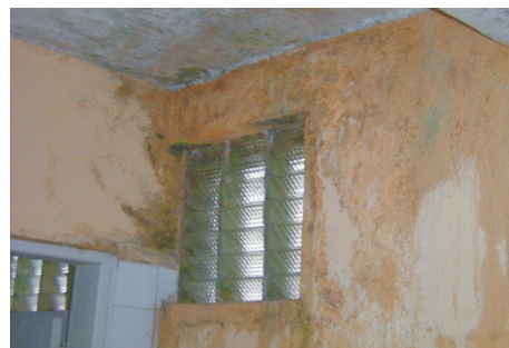
Figura 66 - Infiltrações próximo ao hall dos banheiros no 4º pavimento. Fonte: Espaço Saúde, 2003.
