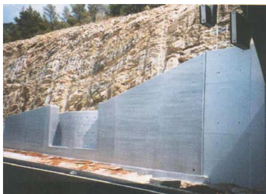
Fig. 49 Muro de contenção de altura variável, Projeto da Via Perimetral Ocidental de Ymmitos , Atenas, 2004.
