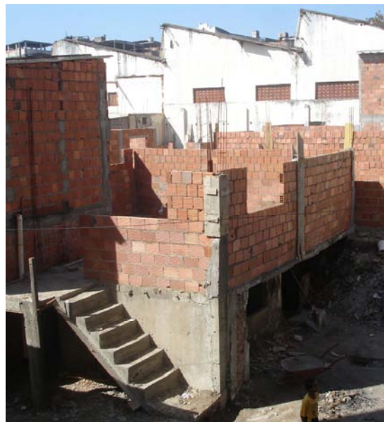
FOTOGRAFIA 61 – Construções em um dos pátios internos em 10 jul. 2007 FONTE: Arquivo Pessoal; AUTORIA: Lilian F. Vaz.
