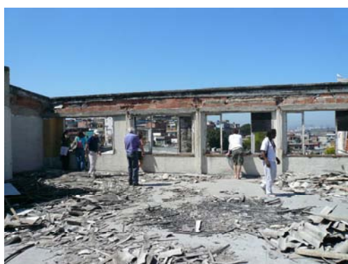
FOTOGRAFIA 42 – O atual "terraço" utilizado para atividades coletivas constituía o quinto andar do edifício, cuja cobertura desabou. FONTE: Arquivo Pessoal. AUTORIA: Carolina Barrozo Torres, 10 jul. 2007.
