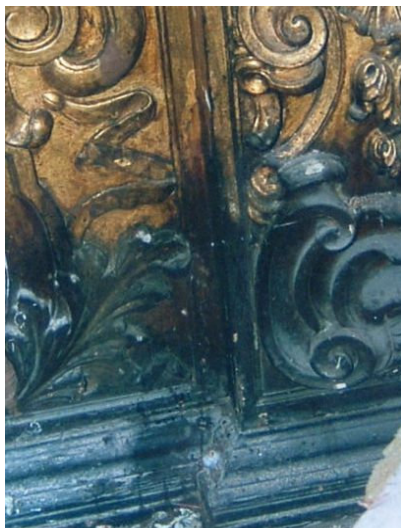
Fig. 46 – Sujidade no painel causada por poluentes (material particulado) Fonte: RG – Conservação e restauração.
