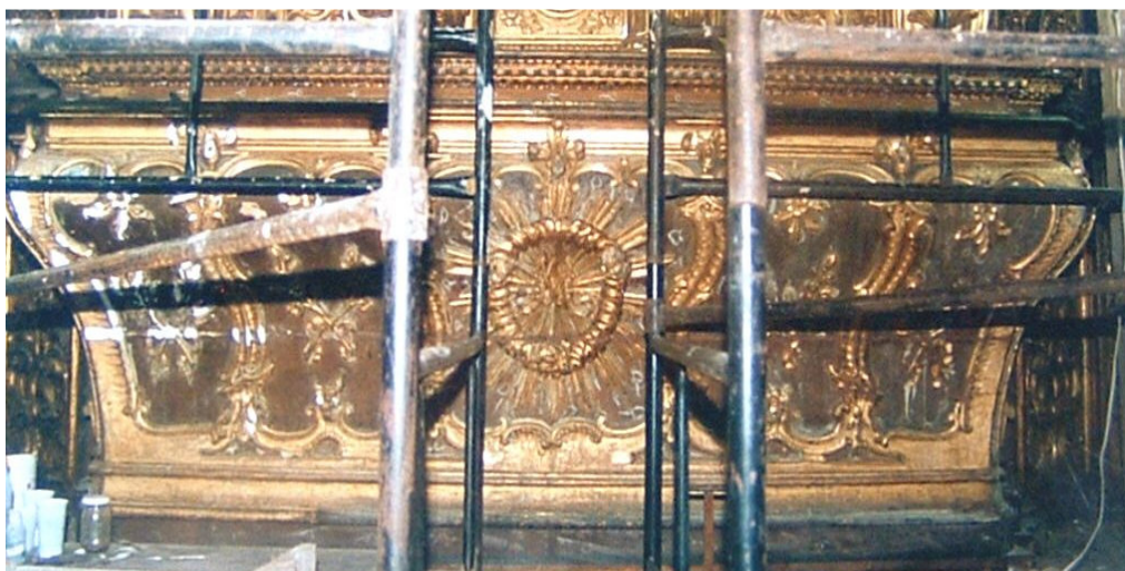
Fig. 78 – Repinturas na mesa do Altar Fonte: RG – Conservação e restauração/Fazendo Arte.
