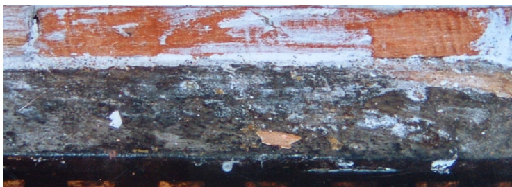
Fig. 47 – Camada de gesso do suporte dos apóstolos danificada pela umidade - Capela Nossa Senhora da Conceição. Foto: RG – Conservação e restauração
