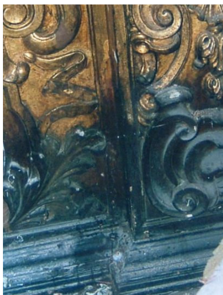
Fig. 52 – Sujidade no painel causada por poluentes (material particulado) Fonte: RG – Conservação e restauração.
