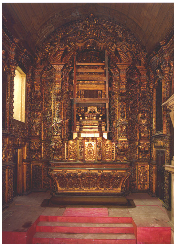
Fig. 84 – Capela Nossa Senhora da Conceição com material particulado (sujidade) e verniz oxidado. Fonte: Projeto RG – Conservação/Restauração/Fazendo Arte
