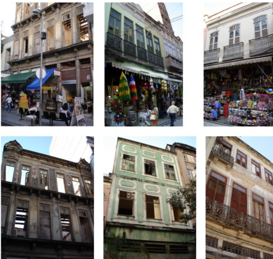
Ilustração 42. Situação dos pavimentos superiores dos sobrados – alguns em bom estado de conservação, outros em estado de ruína. Fonte: autora, 2007.
