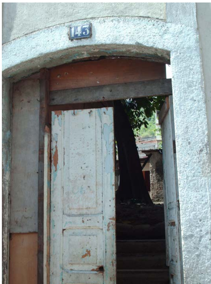
Figura 11 – Imóvel arruinado na Rua do Livramento, 143 com pequenos imóveis construídos no seu interior. Foto do autor, 2008.
