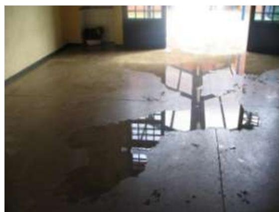
Fig.138- Detalhe da poça d'água no piso do pátio coberto
