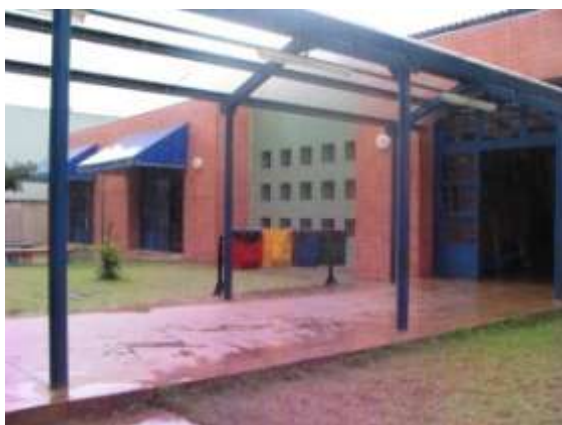
Fig.137- Detalhe da água no piso da circulação
