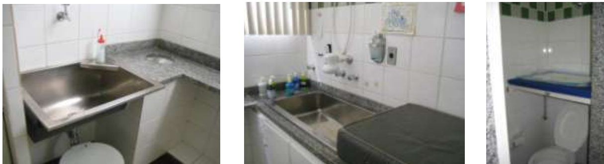
Fig.172- Tanque na área do banheiro Fig.173- Local para banho e troca dos bebês Fig.174- Trocador improvisado
