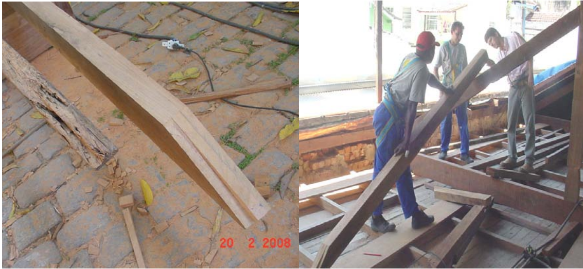
Figura 67 e 68: Linha da tesoura do telhado da Garagem da Casa de Rui Barbosa, onde foram reconstruídas peças da tesoura com os mesmos encaixes e medidas do existente. Na primeira figura vemos a perna da tesoura que foi removida e a perna nova ao lado. Na segunda foto podemos ver a colocação da nova peça no telhado.
