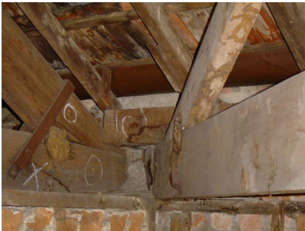
Fig. 42: Marcações sobre as peças de madeira, feitas por uma empresa de descupinização onde foram identificados os focos de cupins ativos (x) e inativos (0). Projeto da Casa DAROS, Botafogo – Rio de Janeiro. Fonte: Arquivo Velatura Restaurações Ltda.
