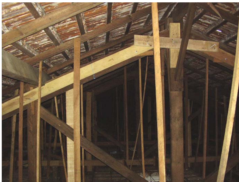
Figura 80: Reforço estrutural emergencial executado com peças de madeira na estrutura do telhado da Paróquia São Francisco de Paula. Situação encontrada antes da restauração.
