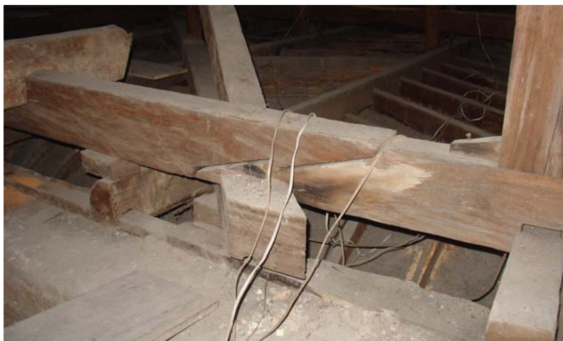
Figura 63: Exemplo de junção com ensabladura entre duas partes de uma linha de tesoura. Situação encontrada no levantamento do telhado da casa Daros onde não havia como afirmar se esta conexão foi criada com o acréscimo de uma nova peças de madeira ou se foi uma junção original.
