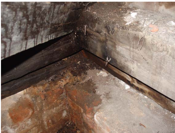
Fig. 50: Exemplo de umidade proveniente da de manutenção das calhas no telhado da casa Daros, Rio de Janeiro. Fonte: Arquivo Velatura Restaurações Ltda.
