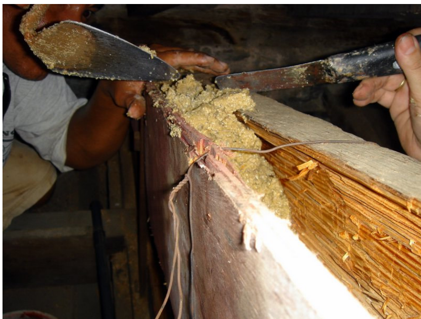
Figura 76: Restauração do telhado da Casa de Villa-Lobos com o uso de apenas areia e resina, sem o auxílio do ferro ou fibras resistentes, nas lacunas provenientes de danos nas estruturas de madeira. Fonte: Foto de Marisa Hoirisch
