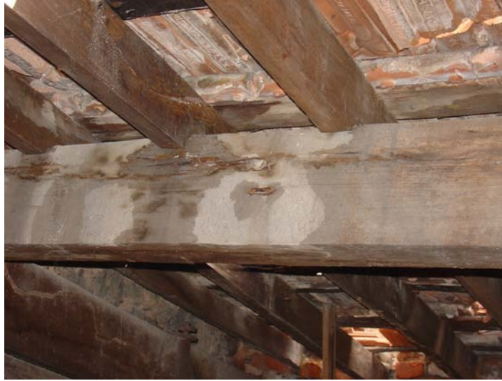
Fig. 48: Exemplo de umidade proveniente da água que infiltrou por ação do vento e de telhas quebradas no telhado da casa Daros, Rio de Janeiro. Fonte: Arquivo Velatura Restaurações Ltda.
