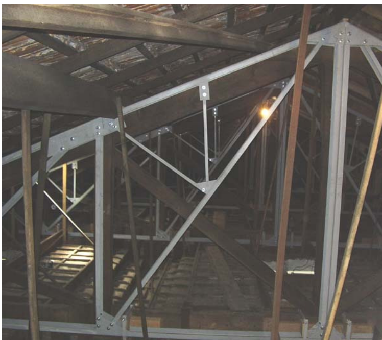
Fig. 41: Exemplo de um projeto de reforço estrutural que descaracterizou a estrutura original do telhado da Paróquia São Francisco de Paula, Curitiba, PR.
