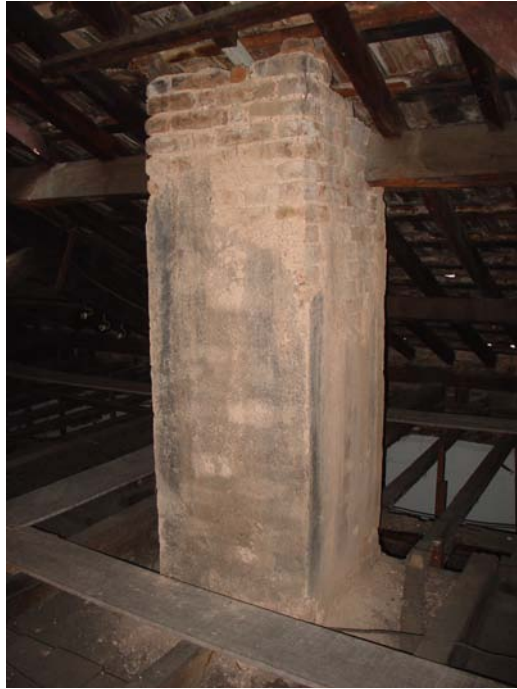
Fig. 40: Vestígios de uma chaminé desativada, encontrados dentro de um telhado. Projeto da Casa DAROS, Botafogo – Rio de Janeiro. Fonte: Arquivo Velatura Restaurações Ltda.
