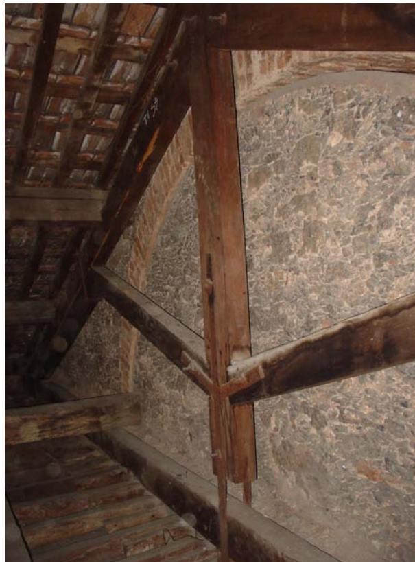
Fig. 39: Vestígios de um arco encontrados dentro de um telhado, que merecia prospecção. Projeto da Casa DAROS, Botafogo – Rio de Janeiro. Fonte: Arquivo Velatura Restaurações Ltda.
