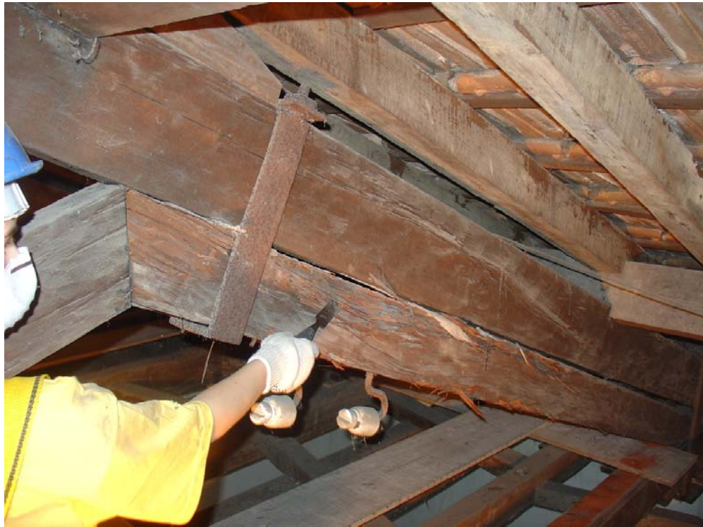
Fig. 44: Exemplo de inspeção feita na estrutura do telhado da casa Daros, Rio de Janeiro, antes do início de mapeamento de danos. Fonte: Arquivo Velatura Restaurações Ltda.
