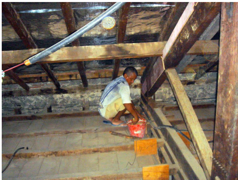
Figura 75: Restauração do telhado da Casa de Villa-Lobos com o uso de apenas areia e resina, sem o auxílio do ferro ou fibras resistentes, nas lacunas provenientes de danos nas estruturas de madeira. Esteticamente a peça apresentará sua forma original, mas estruturalmente à resina poderá não resistir aos esforços. Fonte: Foto de Marisa Hoirisch.
