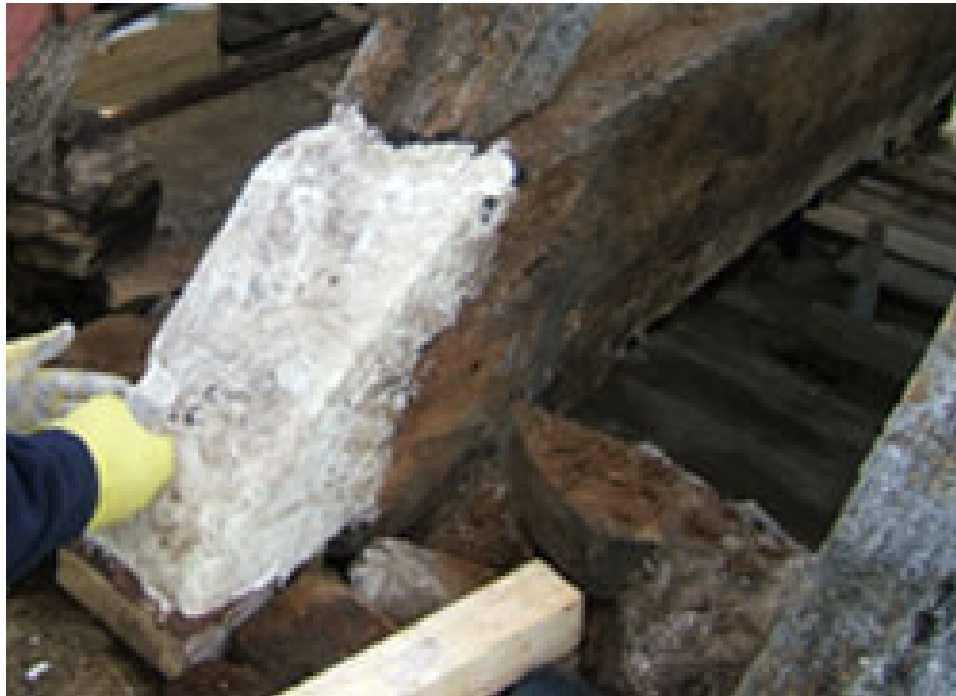
Figura 74: Exemplo de uso inadequado da resina epóxi, onde a linha da tesoura perdeu grande parte de sua seção original, da junção com a perna e provavelmente da sua resistência estrutural.
